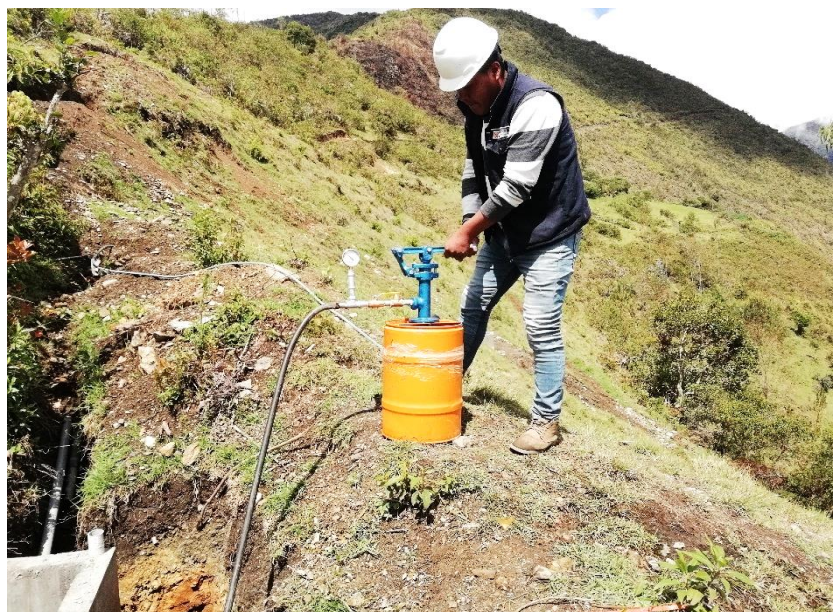
Figura 63: Vista fotográfica en proceso de ejecución de prueba hidráulica en línea de conducción
