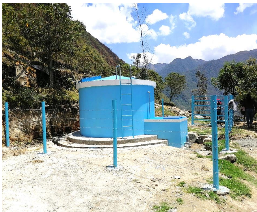
Figura 82: Vista fotográfica de estructura de protección de reservorio de 10 m 3
