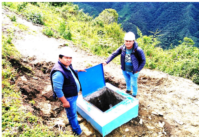
Figura 68: Vista Fotográfica de Cámara Rompe Presión tipo IV en línea de conducción
