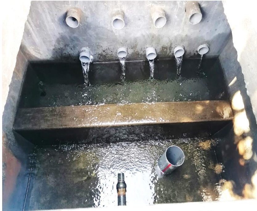
Figura 53: Vista Fotográfica del Funcionamiento de la Cámara Húmeda en la Captación
