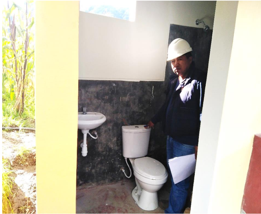
Figura 123: Vista fotográfica de verificación de instalaciones de sanitarios en UBS
