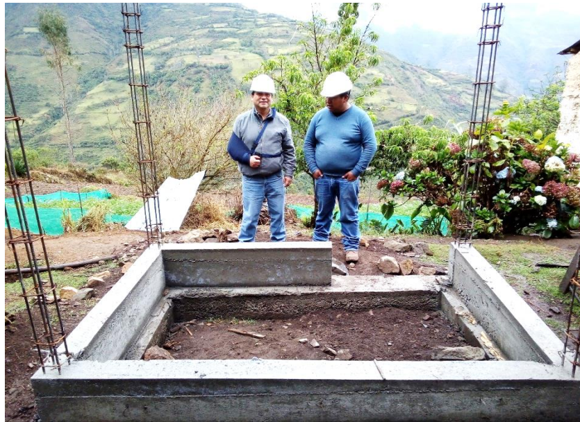
Figura 111: Vista fotográfica de la verificación de la estructura de sobrecimientos en UBS
