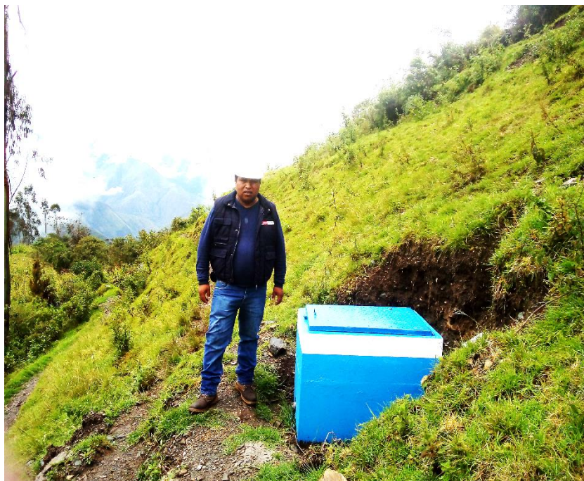
Figura 97: Vista fotográfica de válvula de control ejecutado
