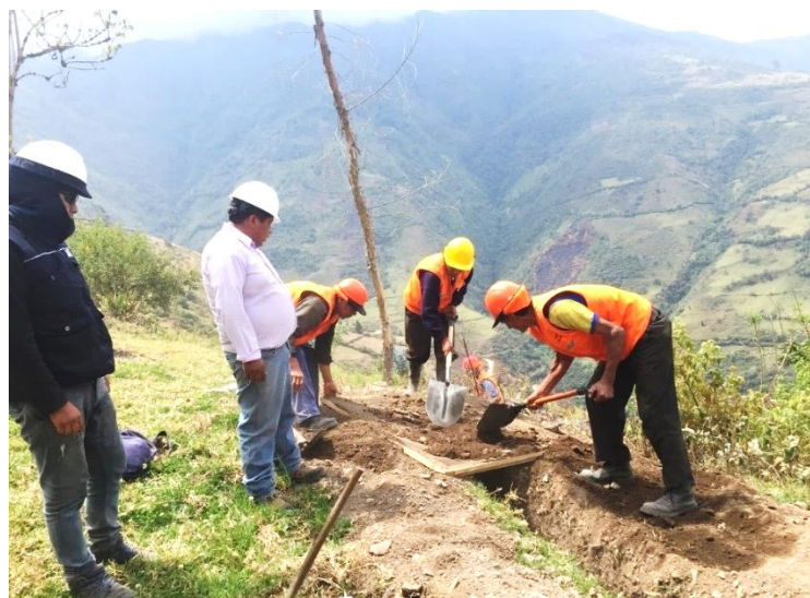
Figura 88: Vista Fotográfica en donde se aprecia el colocado de cama de apoyo para tubería
