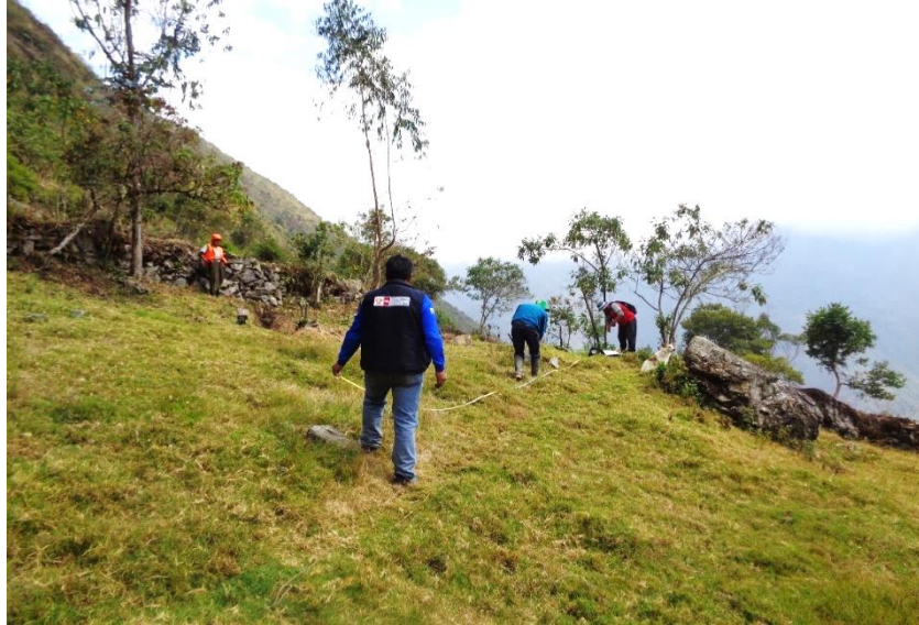
Figura 85: Vista fotográfica en el proceso de trazo y replanteo red de distribución
