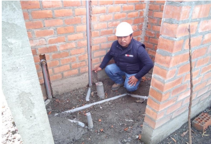
Figura 116: Vista fotográfica de instalaciones sanitarias en interior de UBS
