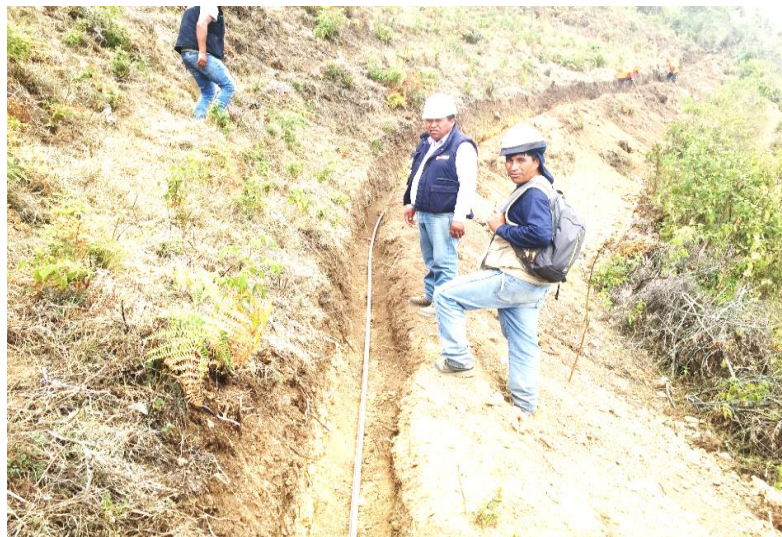
Figura 61: Vista Fotográfica en donde se aprecia la instalación de tuberías de PVC
