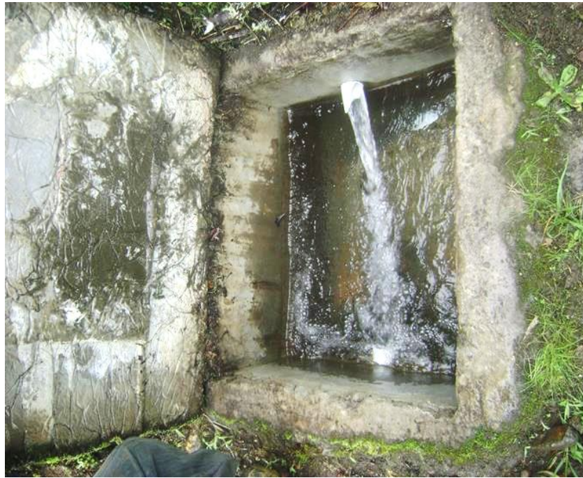
Figura 9: Cámara rompe presión existente CRP-T6
