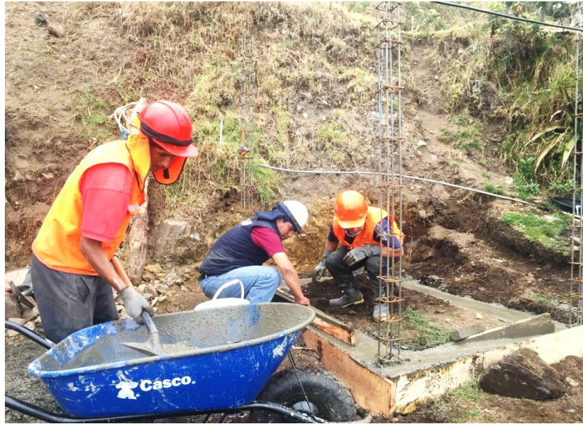
Figura 106: Vista fotográfica en proceso de vaciado de cimientos corridos de UBS
