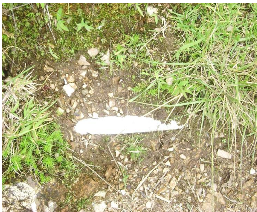
Figura 8: Línea de conducción expuesta.
