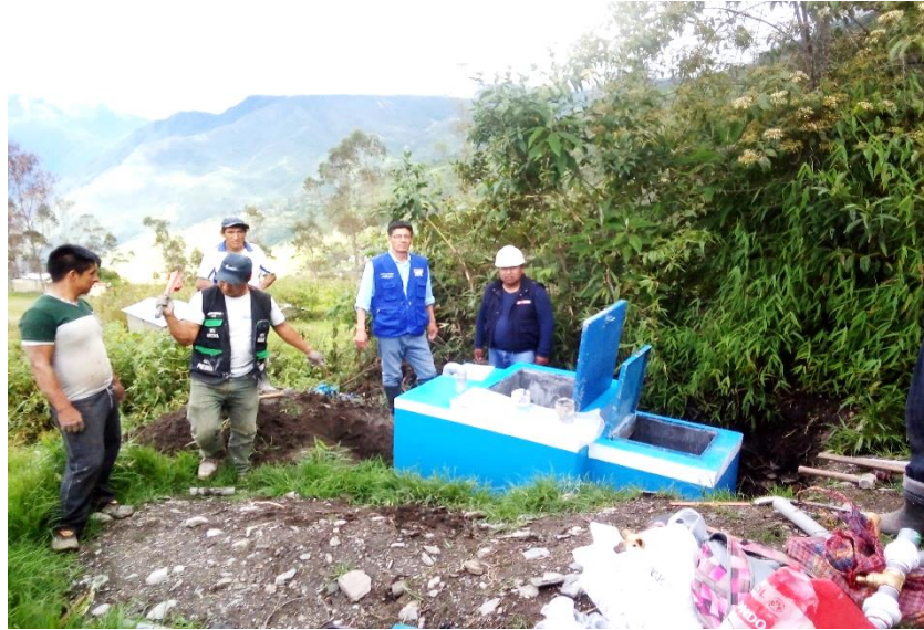
Figura 96: Vista Fotográfica de Cámara Rompe Presión tipo VII en Red de Distribución
