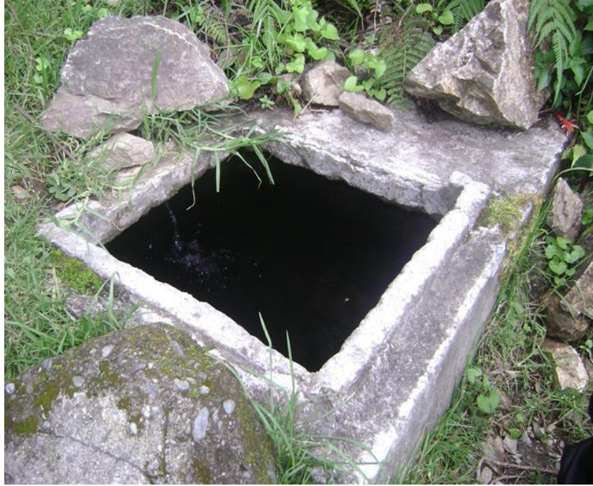
Figura 12: Cámara rompe presión CRP-T7
