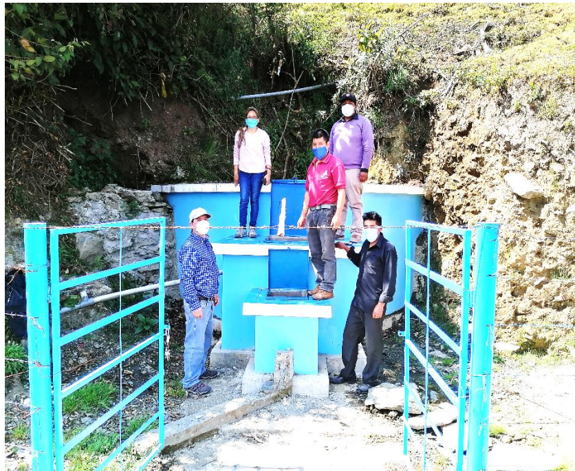
Figura 55: Vista fotográfica de captación Putayako en funcionamiento con cerco de protección
