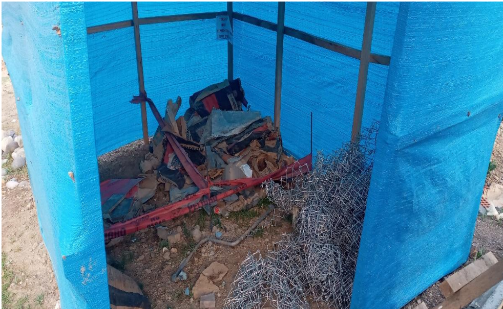
Figura 11: almacenamiento de residuos de construcción en la caseta.
