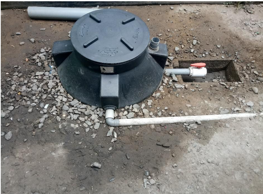
Figura 51. Tanque séptico (biodigestor) instalados
