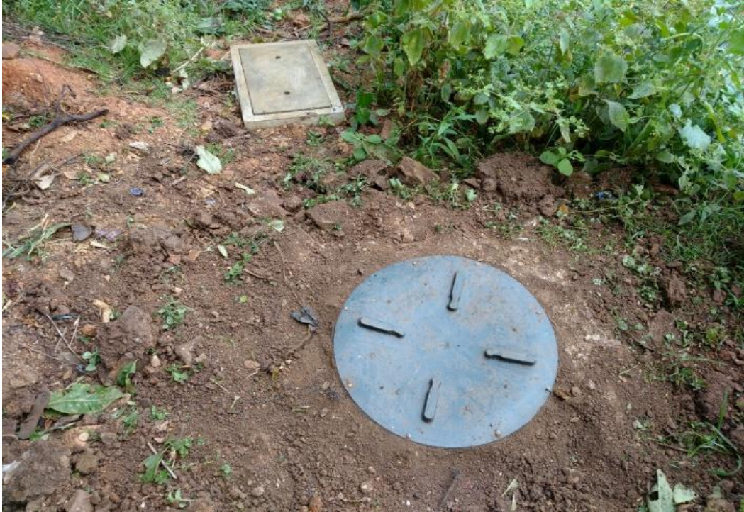
Figura 50. Tanque séptico (biodigestor) y caja de lodos
