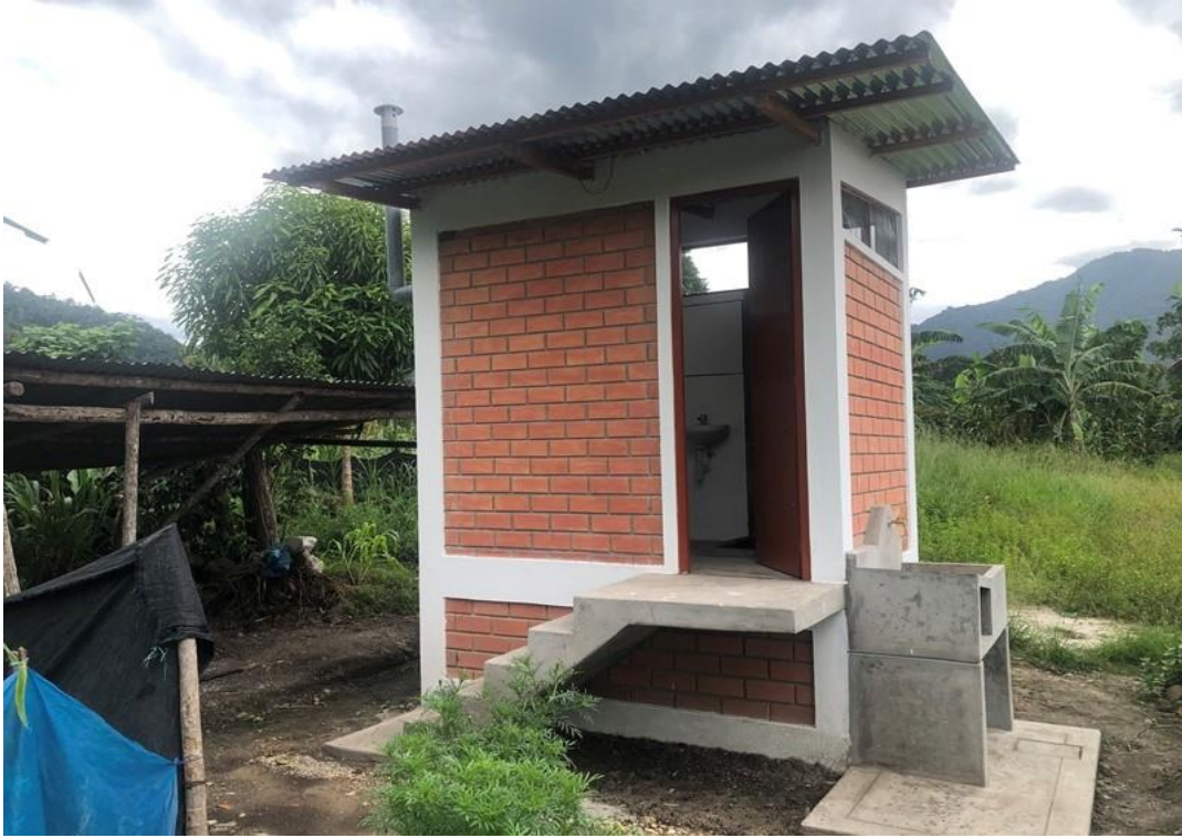
Figura 54. Lavadero multiusos de unidad básica de saneamiento de compostaje continuo
