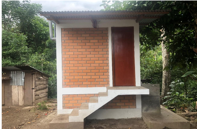
Figura 22. Unidad básica de saneamiento de compostaje continuo – propuesta como opción tecnológica para el centro poblado Betania – San Martín
