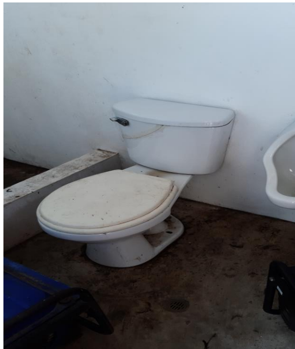
Figura 49. Aparatos sanitarios de unidad básica de saneamiento de arrastre hidráulico
