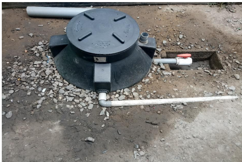
Figura 21. Tanque séptico (biodigestor), sistema de tratamiento de UBS de arrastre hidráulico como opción tecnológica para el centro poblado Betania – San Martín
