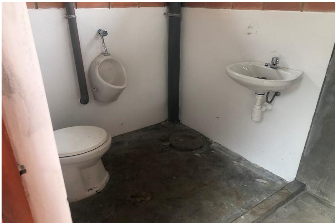
Figura 55. Aparatos sanitarios de unidad básica de saneamiento de compostaje continuo
