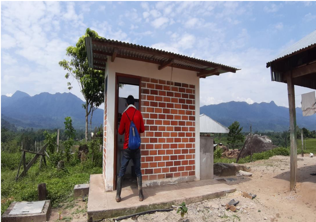
Figura 47. Unidad básica de saneamiento de arrastre hidráulico
