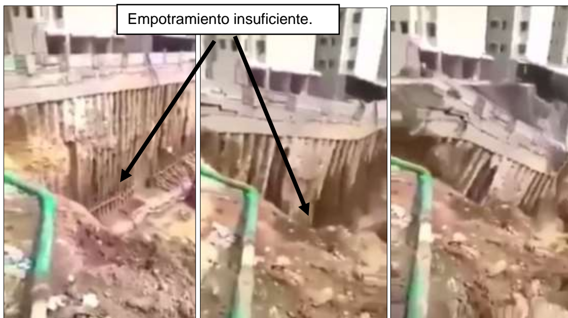
Figura 198: Falla por vuelco en los muros pantalla discontinuo. Fuente: Colapso de muros y vallas (Soto, 2019)
