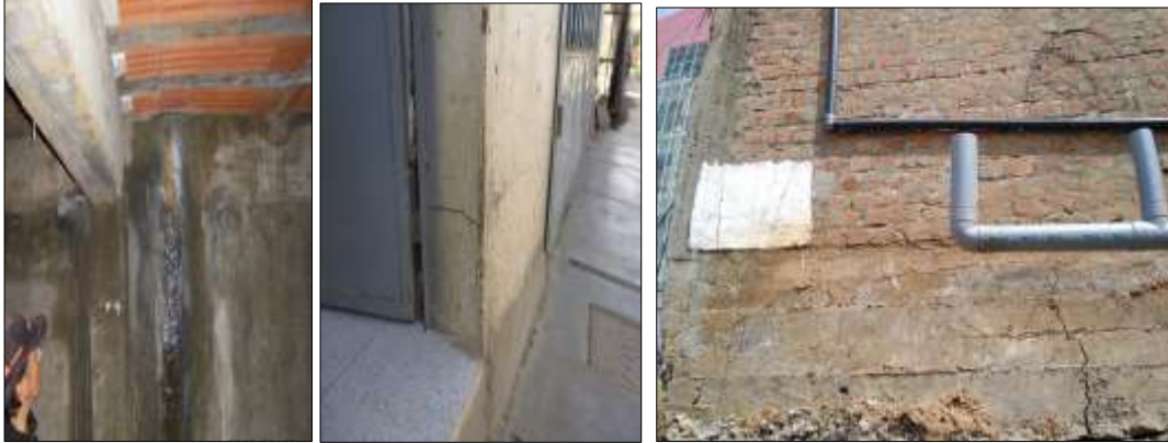
Figura 5: (Izquierda) Filtración de agua subterránea en el muro de sótano en la edificación "Dos Torres" (Centro) Fisuras en las construcciones vecinas a la edificación "Dos Torres; (Derecha) Fisuras en las construcciones vecinas de la Edificación "San Pedro".
