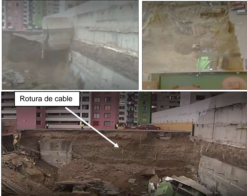
Figura 199: Falla por tracción en el tendón en el distrito de Surco-Lima Perú.
