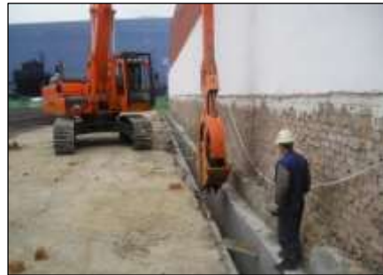
Figura 143: Excavación de zanjas con cucharas bivalva de cable para la inserción de los muros prefabricados.
