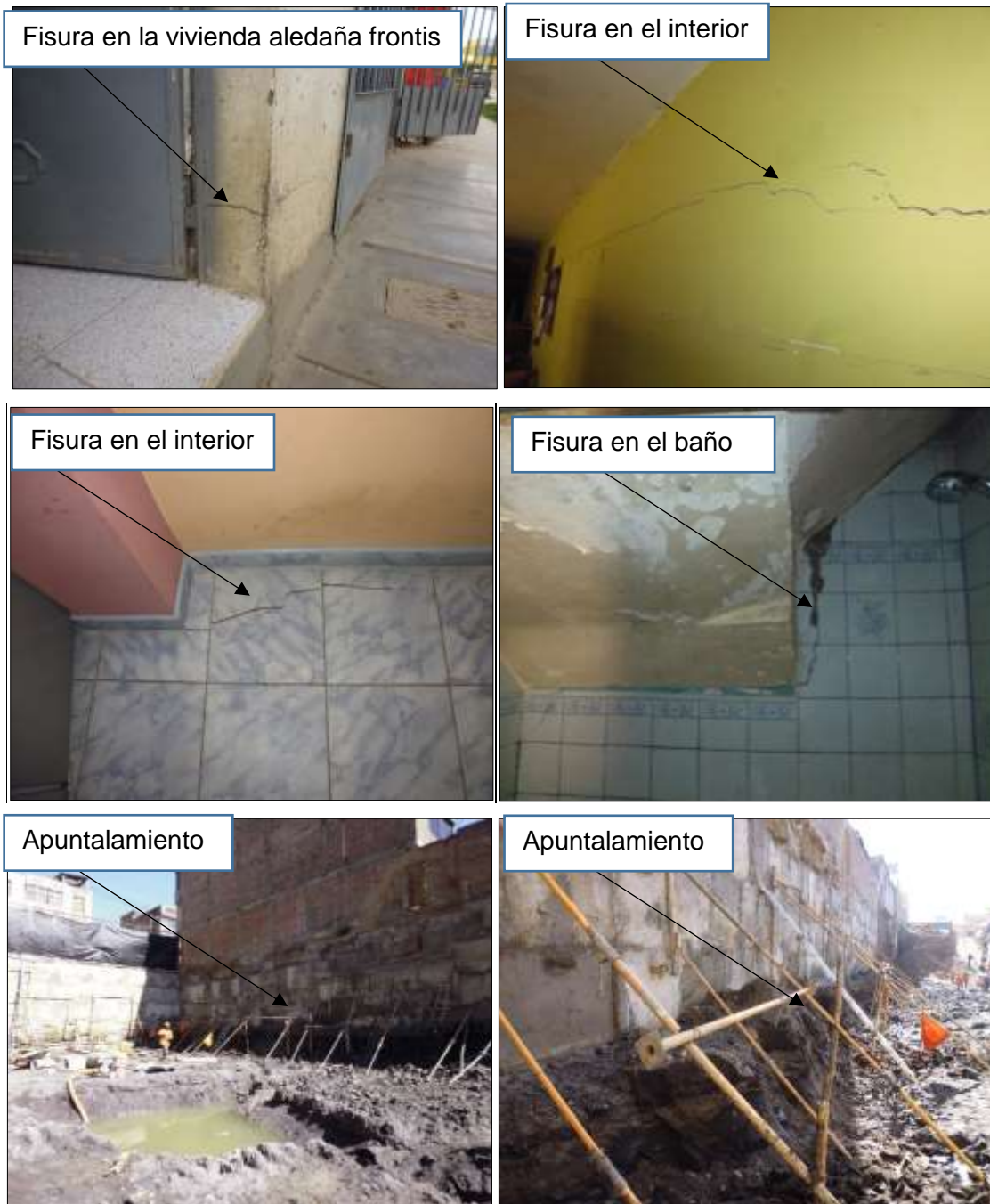
Figura 105: Fisuras en las casas aledañas y apuntalamiento de emergencia.
