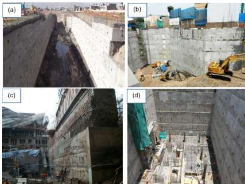
Figura 120: (a) Villa Villaverde Challapampa, Arequipa, 5 sótanos, año 2015, (b) Edificio Multifamiliar Pezet 583, San Isidro-Lima, 7 sótanos, año 2008, (c) Hotel Marriott, Cuzco, 3 sótanos, año 2010. (d) Edificio La Torre Ichma, San Isidro-Lima, 11 sótanos, año 2015.
