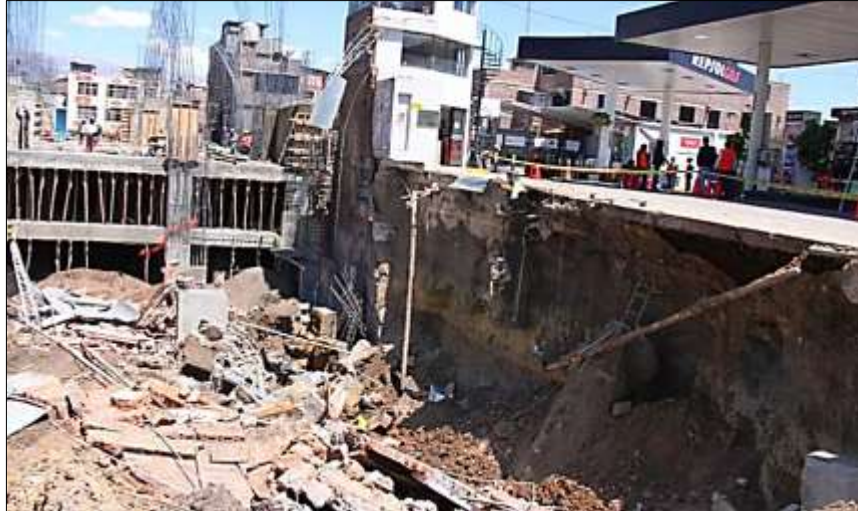
Figura 32: Empuje del terreno sobre los Muros de Sostenimiento en la Construcción “Dos Torres” en Huancayo
