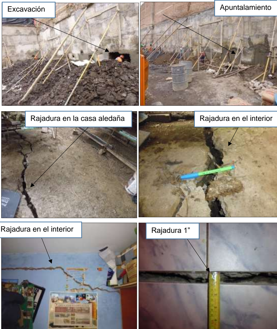
Figura 106: Rajaduras en las casas aledañas y apuntalamiento de emergencia para el cuarto tramo
