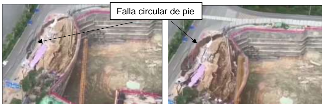
Figura 196: Falla de un muro pantalla por vuelco por falta de empotramiento.
