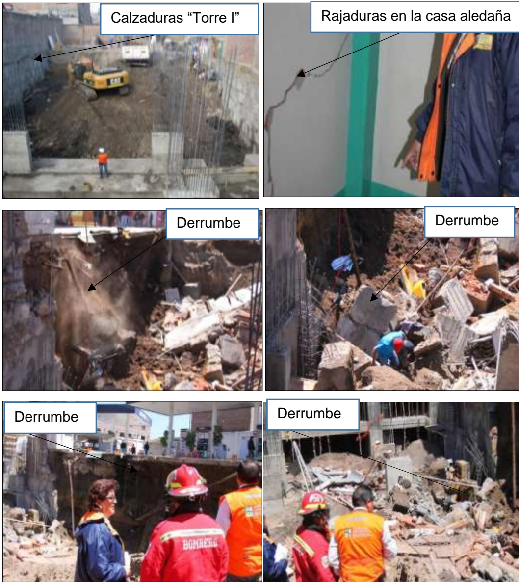
Figura 107: Visibles rajaduras en la propiedad aledaña, y derrumbe en "La Torre I" de la ejecución de calzaduras por inestabilidad del muro.
