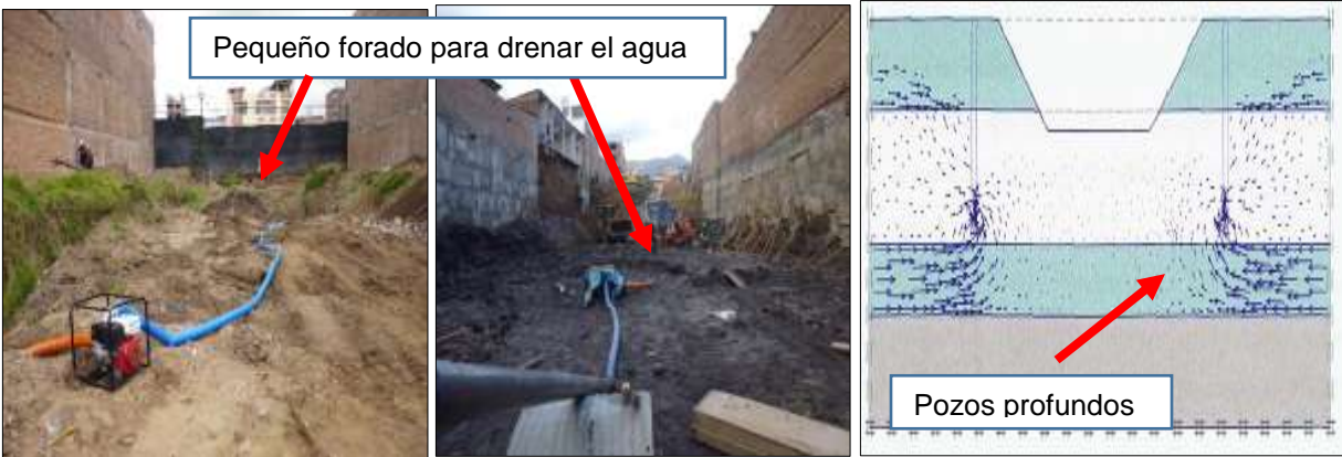
Figura 73: Abatimiento del nivel freático por el método de agotamiento directo y pozos profundos.
