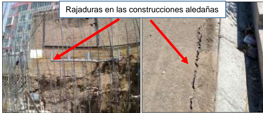
Figura 163: Fisuras en las construcciones aledañas del proyecto "San Pedro"
