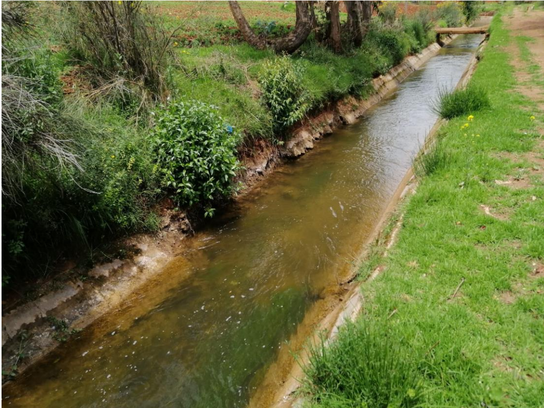
Figura 27. Deterioro de la base y paredes laterales del canal trapezoidal tramo 1+650 km – 1+750 km
