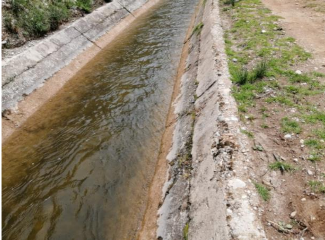
Figura 25. Grietas en las paredes laterales del canal trapezoidal progresiva 0+450 km
