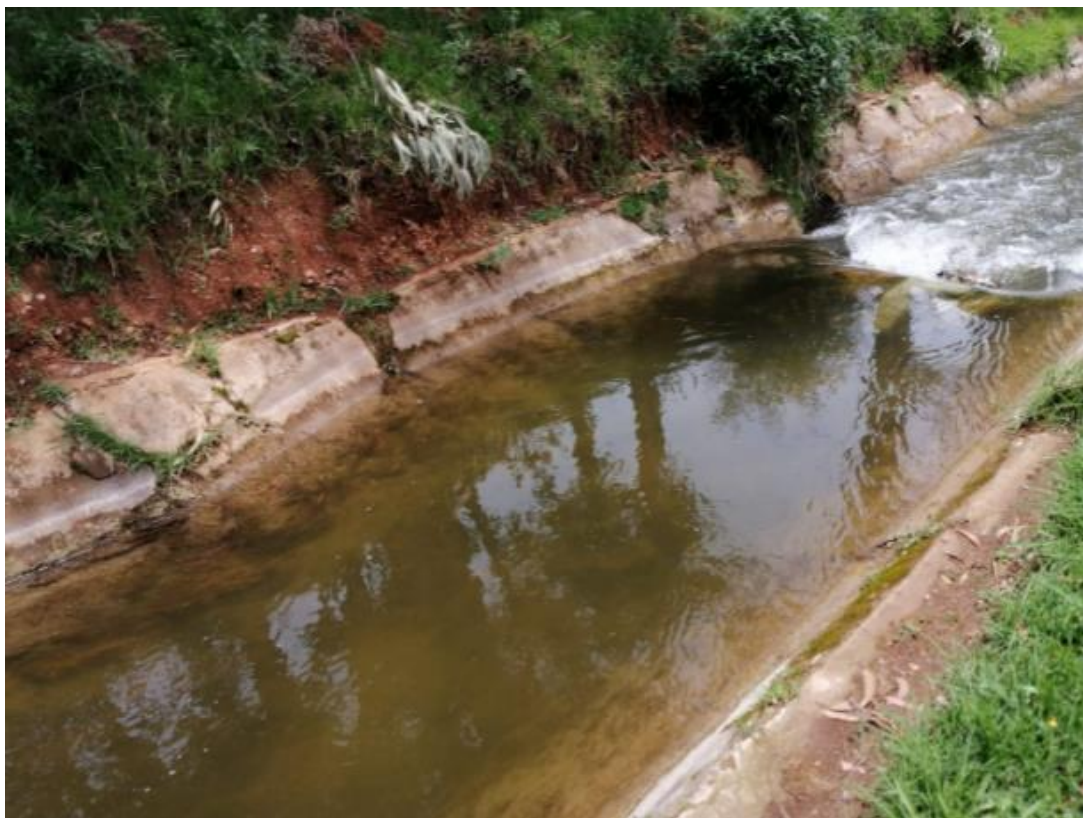
Figura 26. Desprendimiento de las paredes de concreto del canal trapezoidal progresiva 0+950 km
