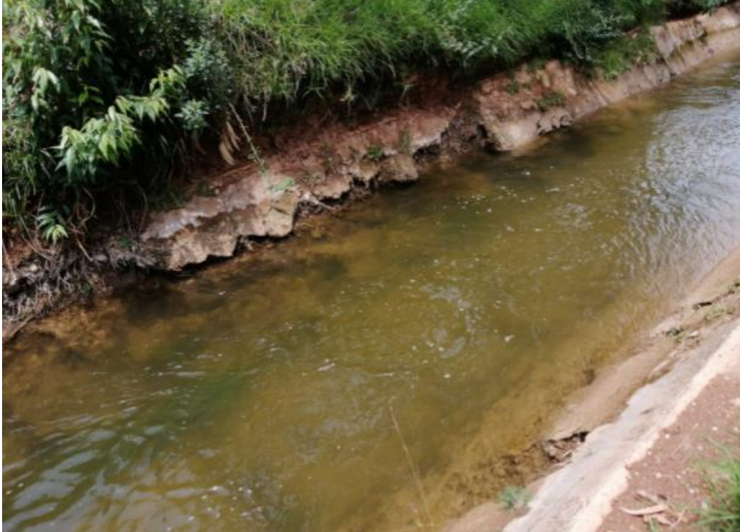
Figura 23. Deterioro de las paredes del canal trapezoidal progresiva 1+060 km
