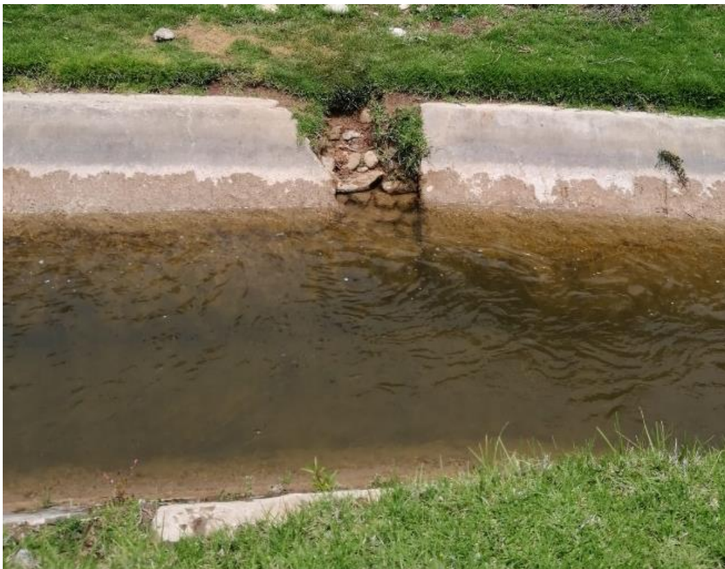
Figura 28. Compuerta clandestina del canal trapezoidal- separación de juntas progresiva 1+850 km
