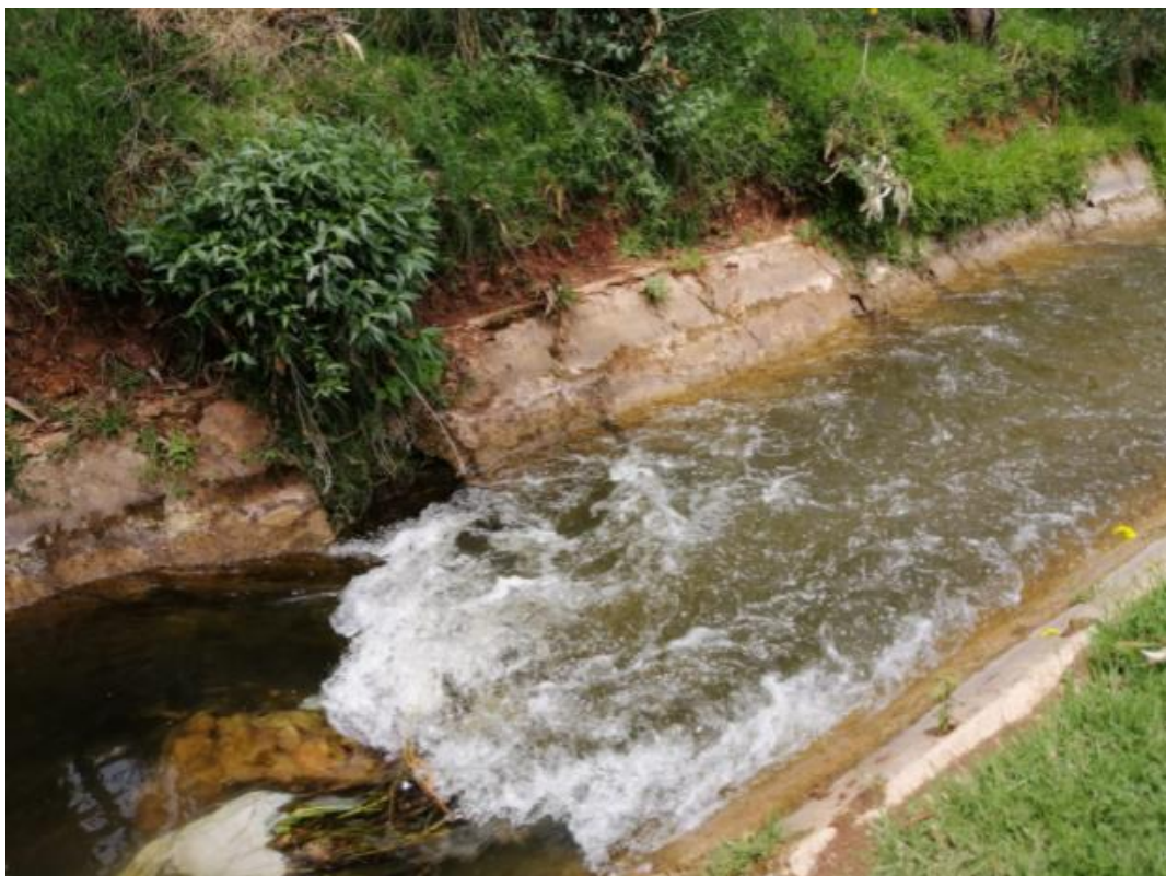
Figura 24. Deterioro de las paredes del canal trapezoidal progresiva 1+100 km
