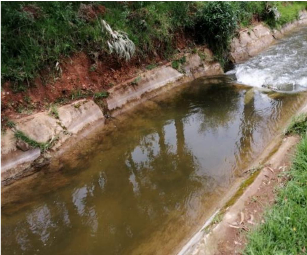
Figura 2. Deterioro de la estructura del canal Huayao
