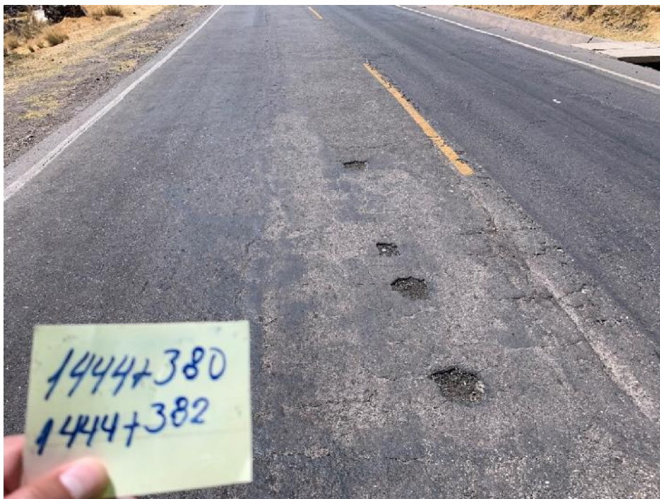
Figura 15. Baches Encontrados en la Calzada de la Vía para Posterior Emisión de la Orden por Defectos No Admitidos
