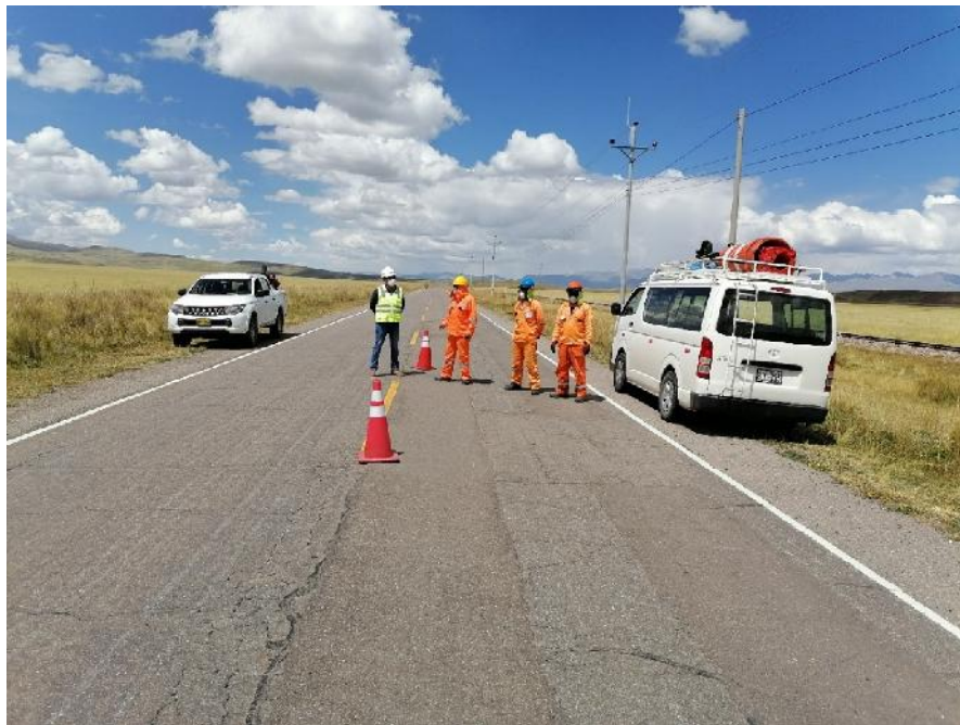
Figura 13. Coordinación con la Cuadrilla sobre Defectos Encontrados en la Vía
