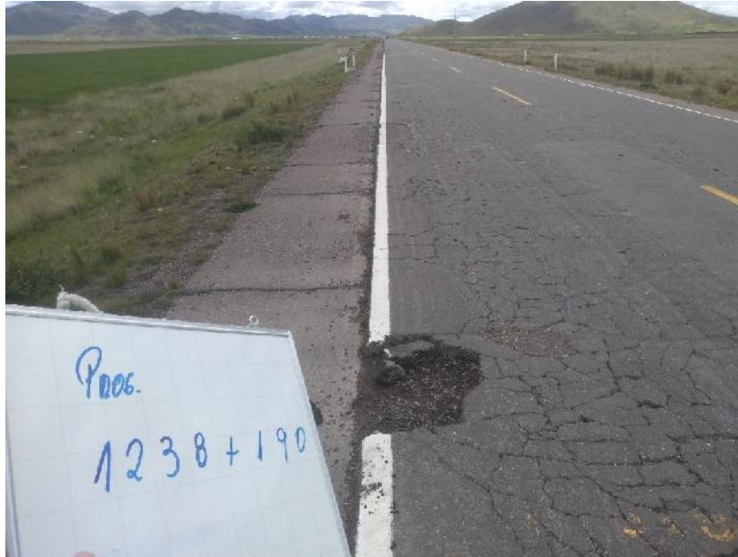
Figura 16. Bache Encontrado en la Vía Durante las Evaluaciones no Programadas para la Posterior Elaboración de la Orden por Defecto No Admitidos
