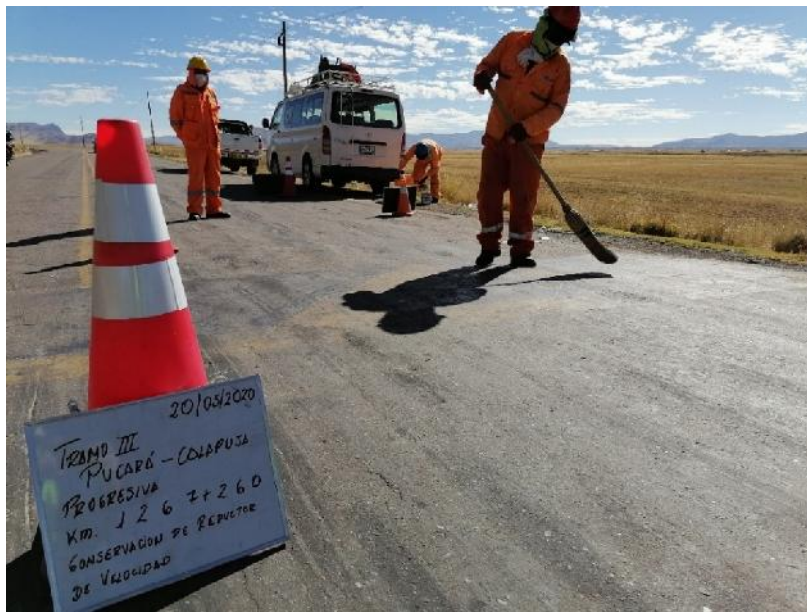
Figura 11. Anotación del defecto encontrado en la vía
