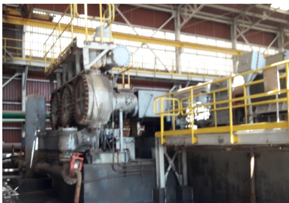
Fuente_ imagen tomada en la sala de bombas pistón-diafragma
