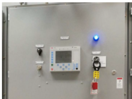
Figura 1. Modo mantenimiento de los switchgear
