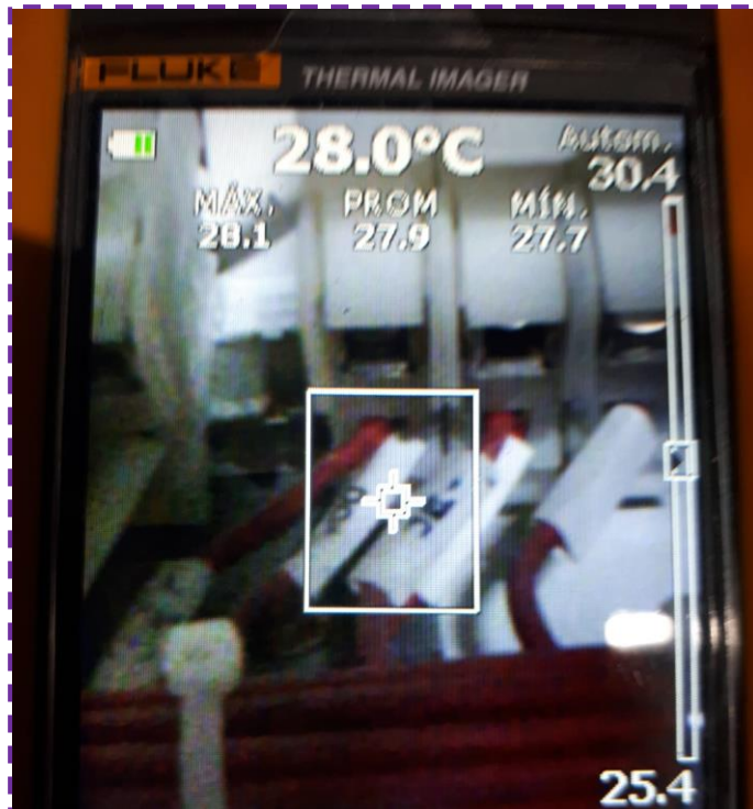
Figura 63. HMI Visualización termografica correcta del circuito eléctrico sin fallas
