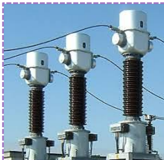
Figura 33. Transformadores de medida. Tomado de Arteche
