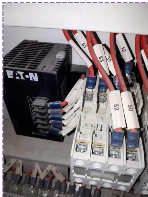
Figura 59. Zoom de conexionado eléctrico con fuente EATON
