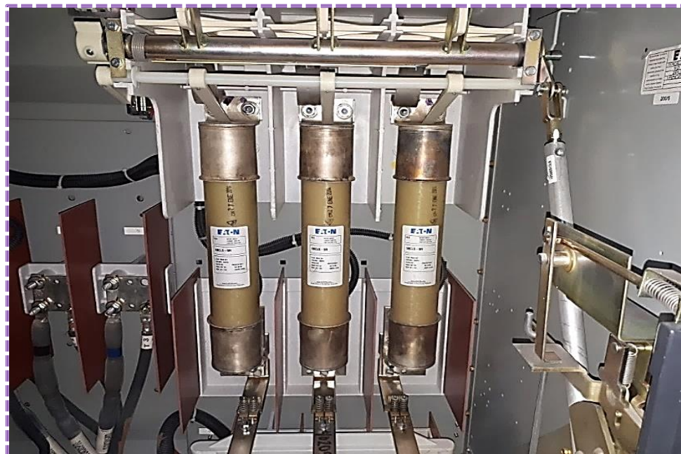
Figura 50. Conexión antigua de la línea de 4160 VAC
