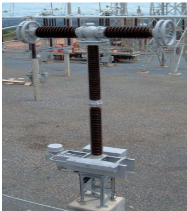
Figura 26. Interruptor de by-pass rápido
