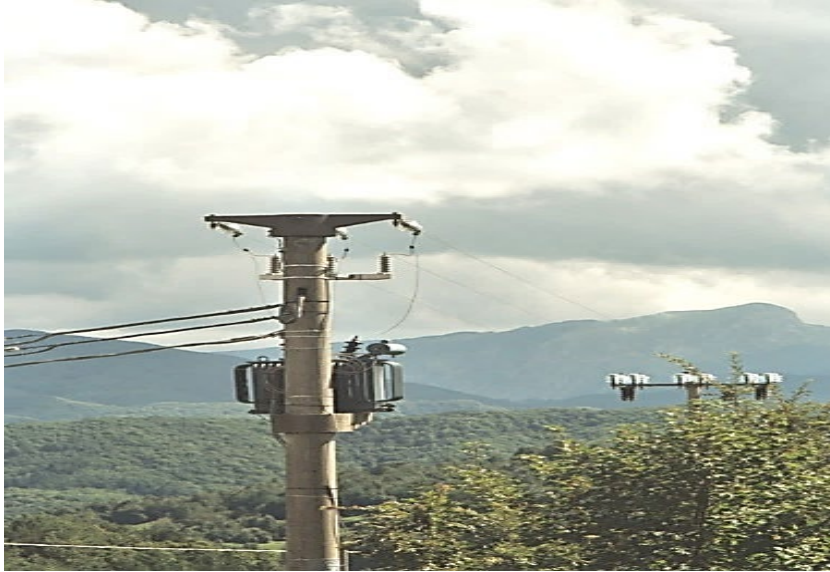
Figura 9. Apoyo especial de alta tensión a baja tensión Fuente: http://www.tuveras.com/lineas/aereas/lineasaereas
