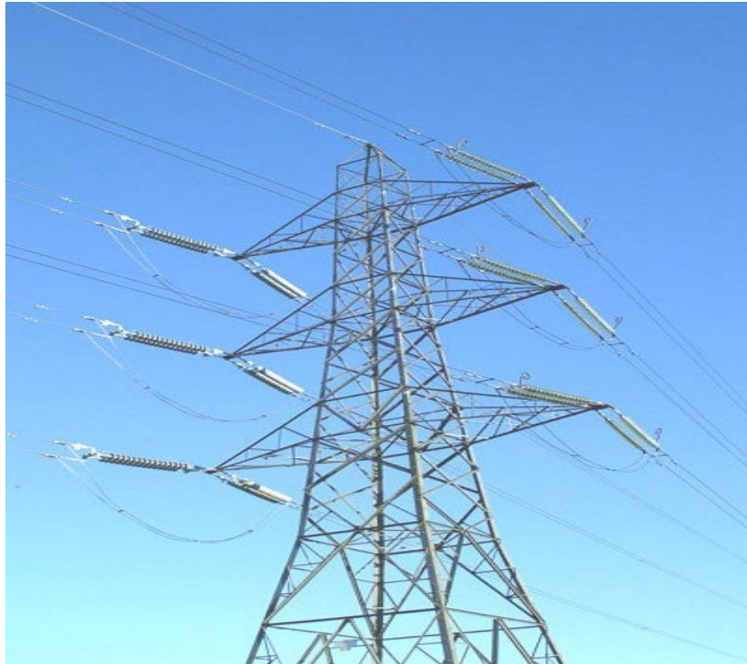
Figura 7. Apoyo de anclaje doble de doble terna Fuente: http://www.tuveras.com/lineas/aereas/lineasaereas
