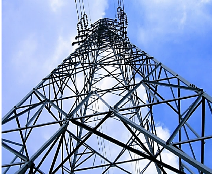
Figura 10. Apoyo de celosía de perfiles laminados de entramado Fuente: https://electromundo.pro/wp-content/uploads/2020/02/1-Torre-de-celos%C3%ADa.jpg
