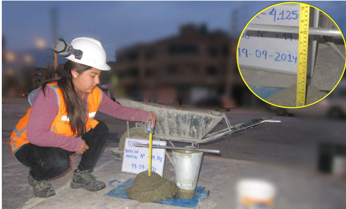
Fotografía 39: Control de asentamiento 8" de slump de dosificación de 19.06g de aditivo Sika Cem Plastificante del embolsado Topex.
