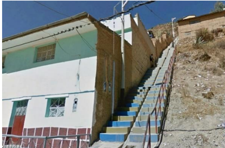
Figura 22. Edificaciones con fallas estructurales
