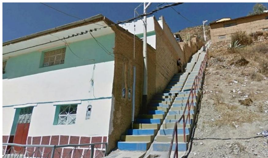
Figura 31. Viviendas ubicadas en laderas de cerro con fallas estructurales Fuente: Google Earth
