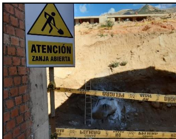
Figura 28. Señalética de zanja abierta, ubicada en el nivel secundaria, en la zona de excavación para el muro de contención en construcción.
