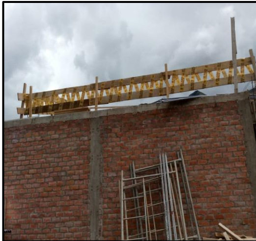
Figura 38. Cerco de madera y cintas de seguridad en la zona de trabajo.
