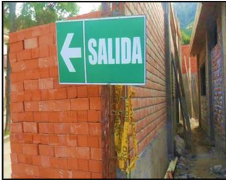
Figura 22. Señalización de salida localizada en el nivel inicial
