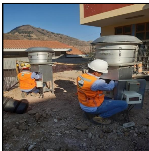
Figura 86. Instalación de los equipos para el monitoreo de la calidad del aire.
