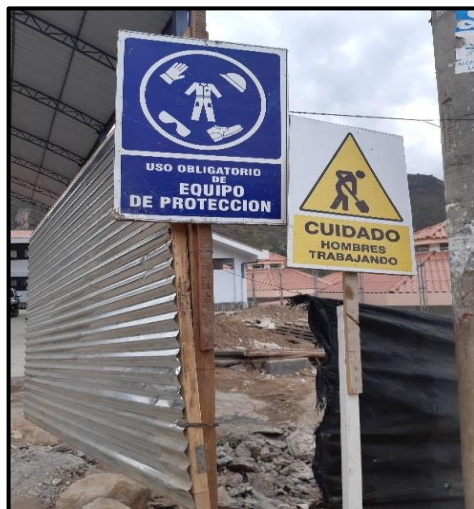
Figura 31. Señalización de EPP y Cuidado hombres trabajando.
