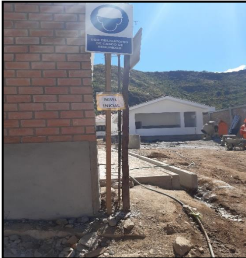
Figura 29. Señalización de uso de EPP en la entrada al nivel inicial.
