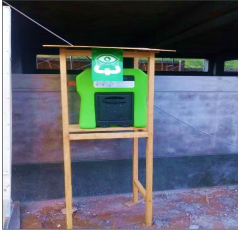
Figura 24. Señalización para el equipo de lavado de ojos (uso en caso de emergencias).
