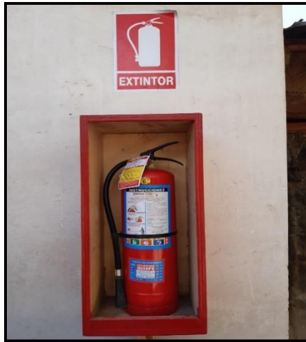
Figura 43. Extintor señalado ubicado en el almacén de obra.
