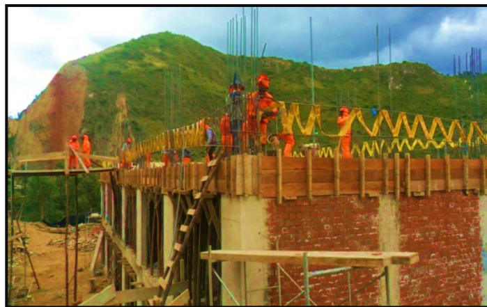
Figura 34. Señalización con cintas de seguridad en todo el contorno de techo para el vaciado de techo del tercer nivel.
