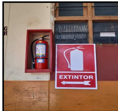
Figura 46. Extintor ubicado en el nivel primario del proyecto.
