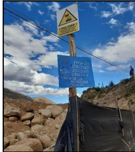
Figura 30. ¡Peligro! Maquinaria en movimiento, ubicado en la entrada de máquinas.
