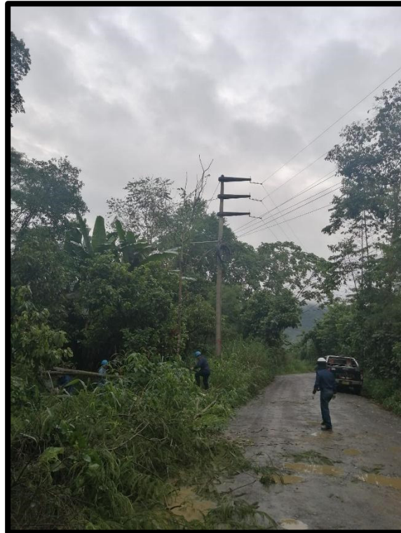
Figura 8. Inspección de las deficiencias y problemáticas de las redes eléctricas del A4028
