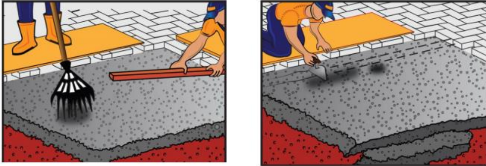
Figura 4. Uniformidad de la superficie de la cama de arena de asiento. Tomada de «Guía de instalación de adoquines de concreto», por Instituto del Cemento y del Concreto de Guatemala, 2017, p. 25.
