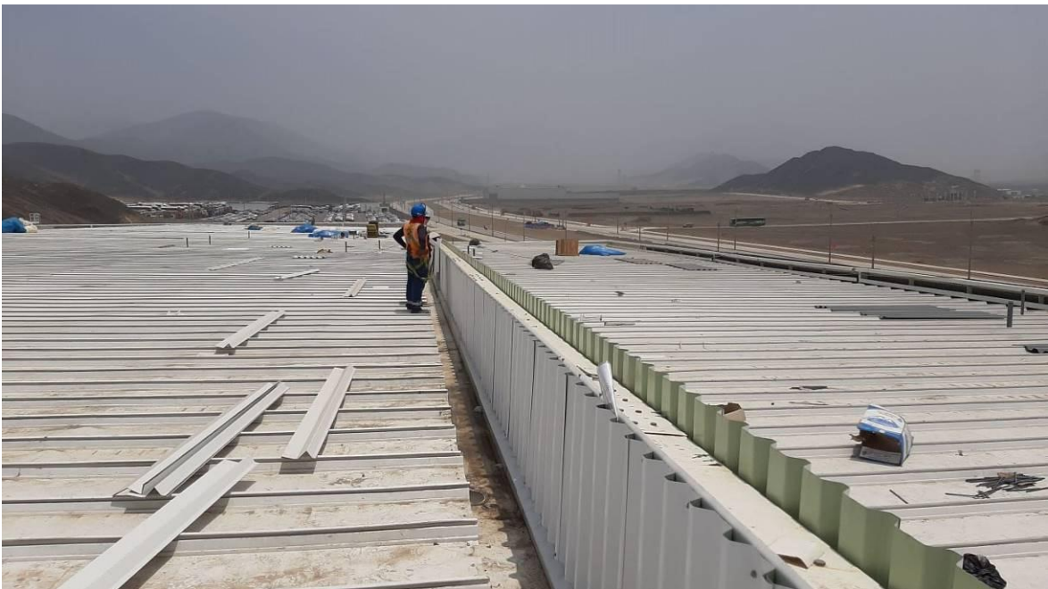
Figura 46. Evaluación Previa al inicio de trabajos sobre techo, se prohíbe el inicio hasta la instalación de líneas de vida colectiva
