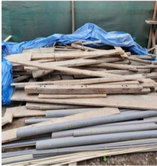
Figura 8. Hallazgo de Maderas acopiadas con clavos expuestos / Estos debieron ser retirados antes de su acopio
