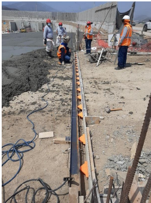
Figura 48. Montaje de Riel, para portón corredizo –Patio de Maniobras, se para la actividad por la proximidad de personas en el esmerilado de estructura metálica
