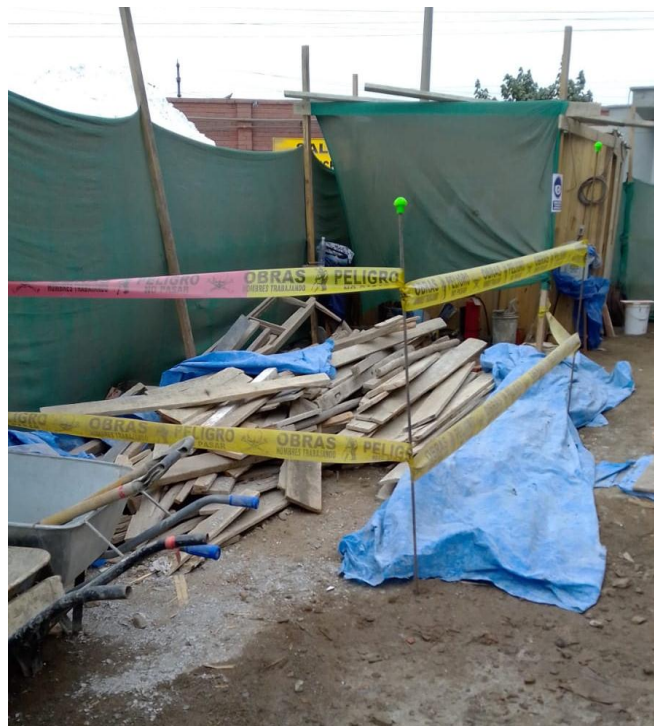
Figura 9. Levantamiento de observación de clavos expuesto de maderas
