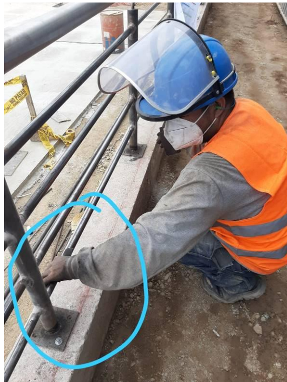
Figura 42. Colaborador no utiliza de manera correcta el EPP entregado, se paraliza la actividad y se brinda la retroalimentación respectiva
