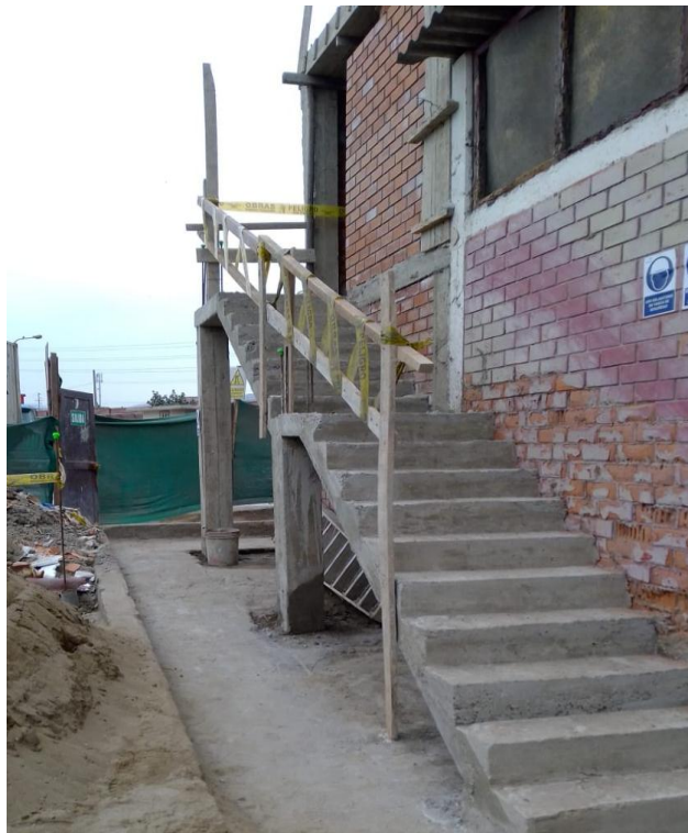
Figura 13. Levantamiento de observación barandas temporales subestándar
