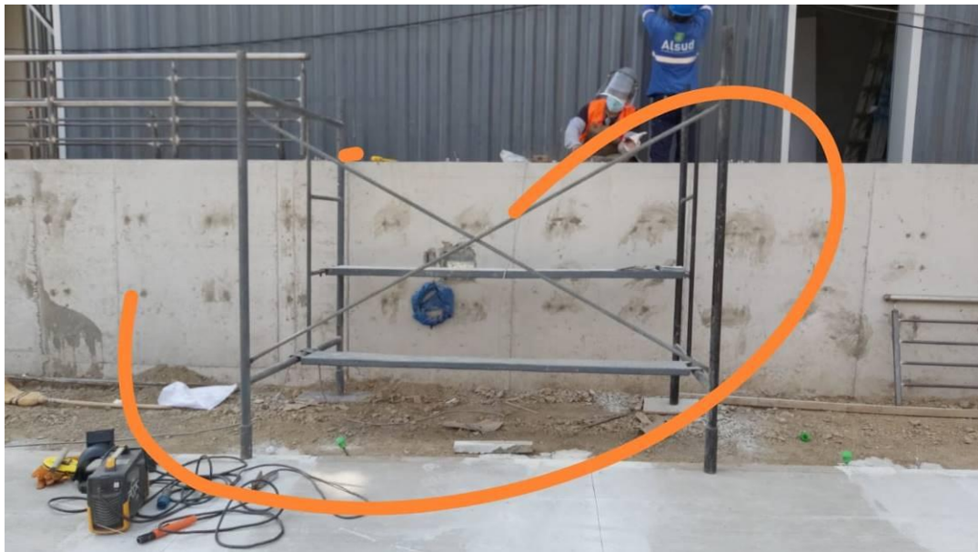
Figura 44. No se limita el área de trabajo y no cuenta con extintor para iniciar trabajos en caliente
