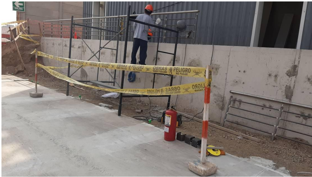
Figura 45. Levantamiento de correcta limitación y extintor en el área de trabajo
