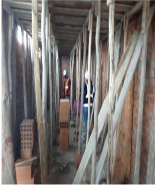
Figura 10. Puntales de madera y desorden en el Área de trabajo
