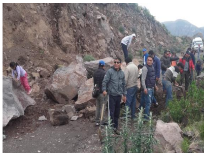
Figura 2. Talud en deslizamiento Fuente: Elaboración propia
