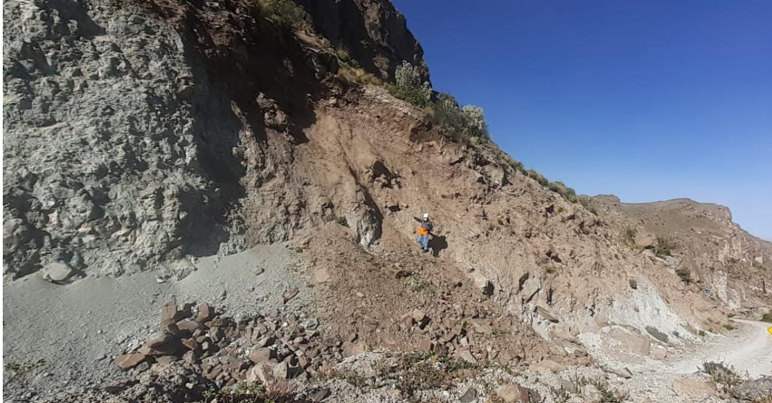
Figura A1.3: Trabajos en campo – identificación de fallas de taludes Fuente: elaboración propia
