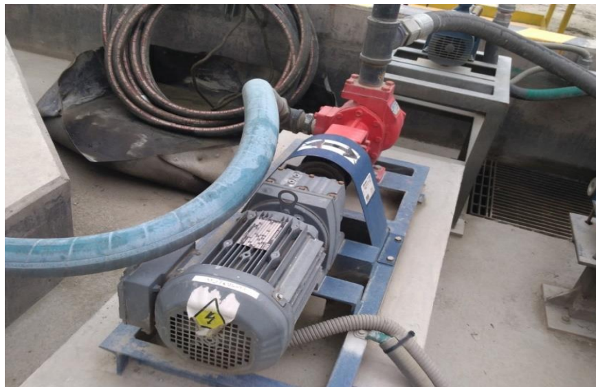
Figura 33. Bomba eléctrica para descarga de tanque aceite usado. Tomado de: Manual de mantenimiento. Unidad Minera Constancia (18)
