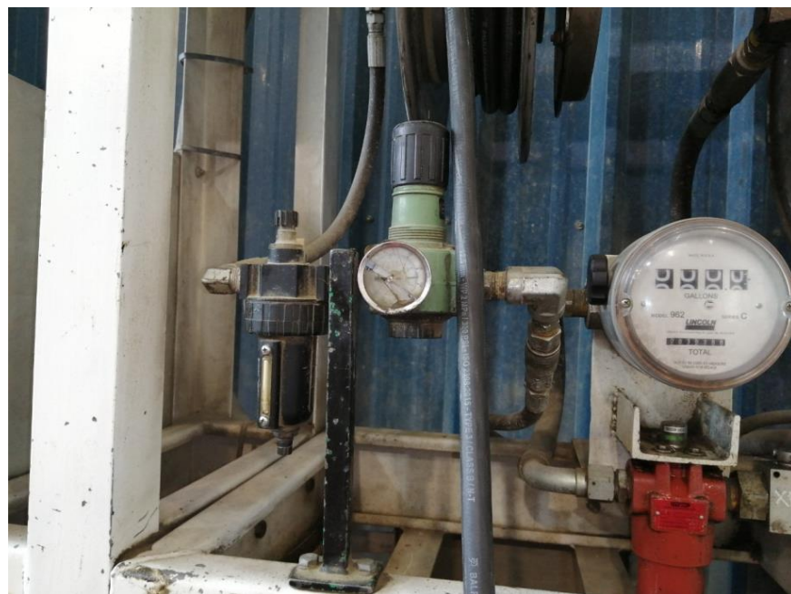
Figura 45. Unidad de mantenimiento de carrete. Tomado de: Manual de mantenimiento. Unidad Minera Constanca (18)
