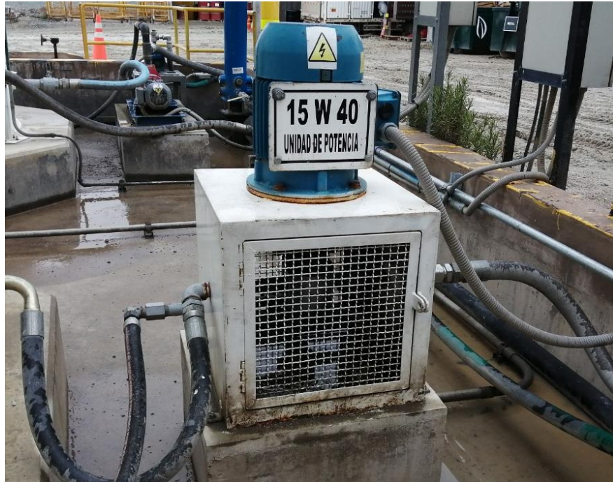
Figura 28. Bomba electrohidráulica. Tomado de: Manual de mantenimiento. Unidad Minera Constancia (18)
