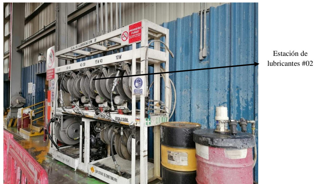
Figura 7. Estación de lubricantes 2. Tomado de: Diagnóstico del área de mantenimiento Unidad Minera Constanca
