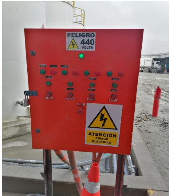
Figura 55. Mantenimiento del equipo eléctrico con propuesta
