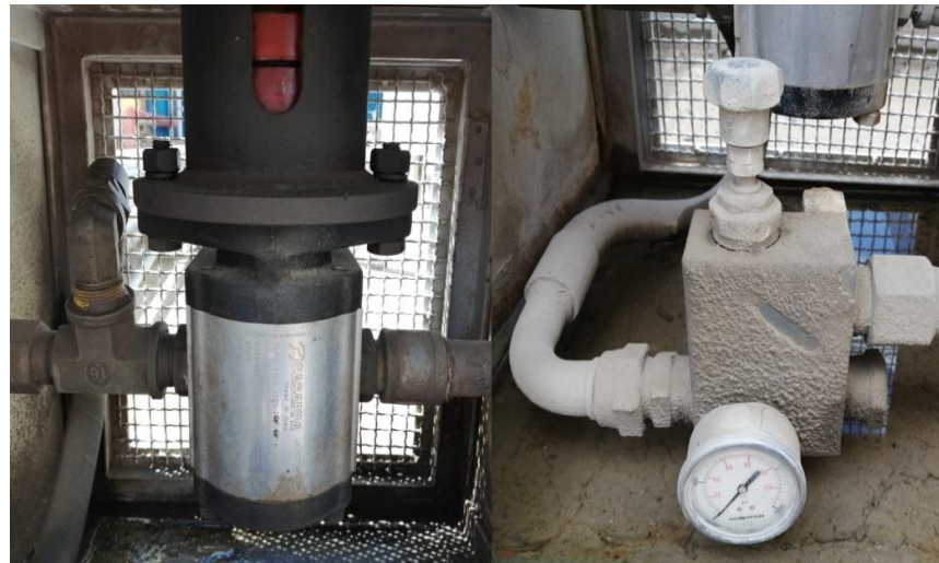
Figura 29. Bombas de zona de tanques. Tomado de: Manual de mantenimiento. Unidad Minera Constancia (18)
