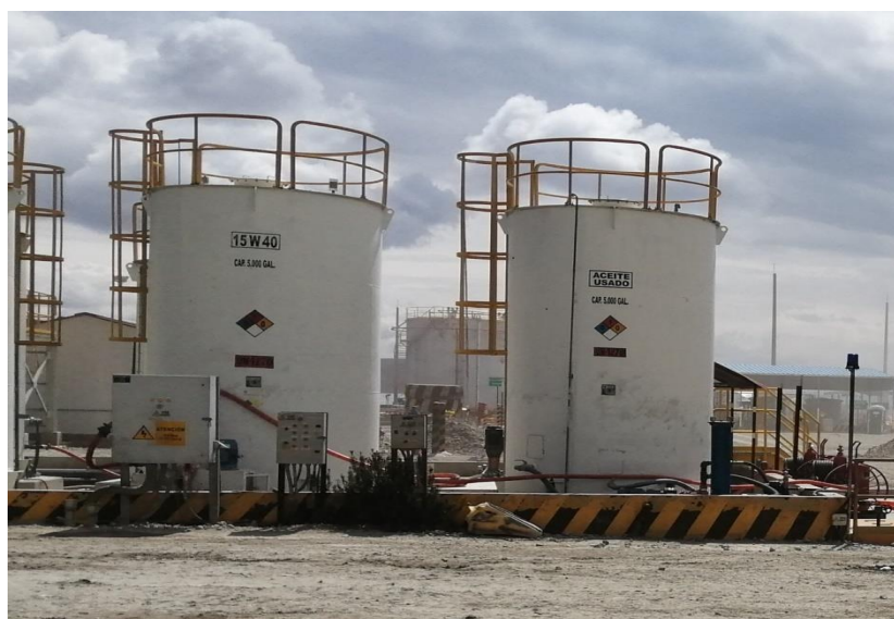
Figura 27. Tanques de almacenamiento. Tomado de: Manual de mantenimiento. Unidad Minera Constanca (18)
