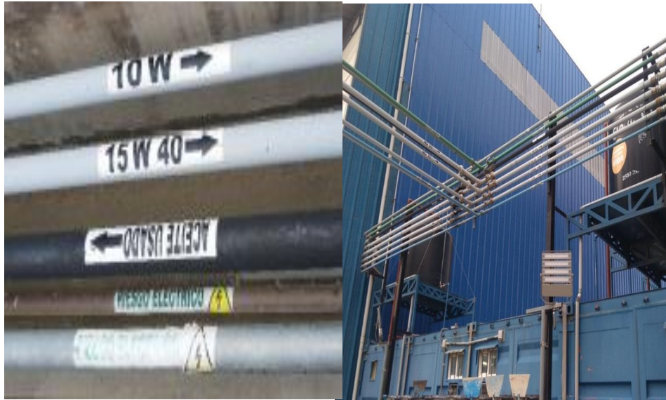
Figura 34. Tuberías. Tomado de: Manual de mantenimiento. Unidad Minera Constanca (18)
