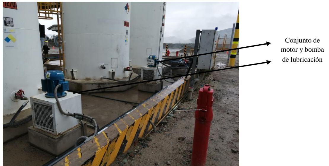
Figura 3. Estación de motores y bombas de lubricación. Tomado de: Diagnóstico del área de mantenimiento Unidad Minera Constancia
