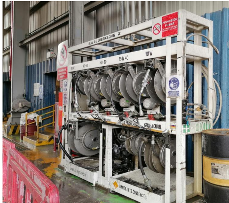
Figura 12. Rack de lubricación en paralelo. Tomado de: Manuales de Sistema de Lubricación en la Unidad Minera Constanca
