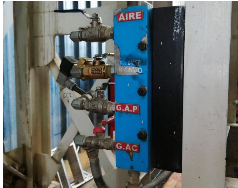
Figura 46. Válvulas para bombas neumáticas. Tomado de: Manual de mantenimiento. Unidad Minera Constancia (18)
