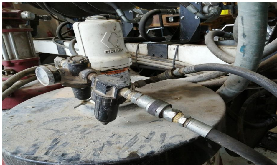
Figura 35. Bomba de grasa. Tomado de: Manual de mantenimiento. Unidad Minera Constanca (18)
