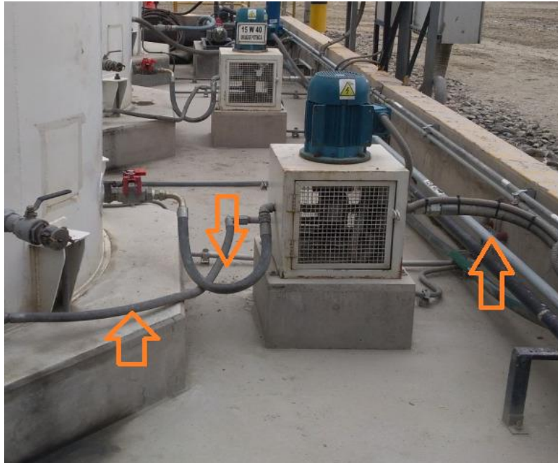
Figura 30. Mangueras hidráulicas de succión y retorno. Tomado de: Manual de mantenimiento. Unidad Minera Constancia (18)
