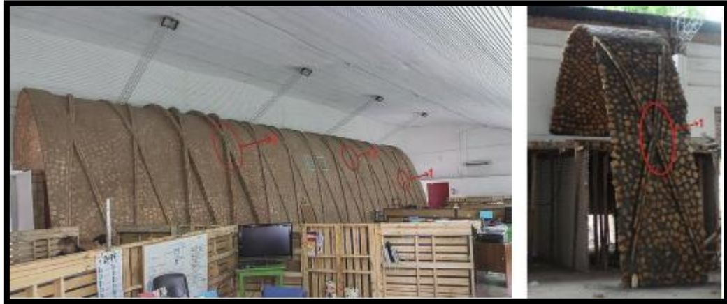
Figura 11: Análisis estructural bóveda interior
