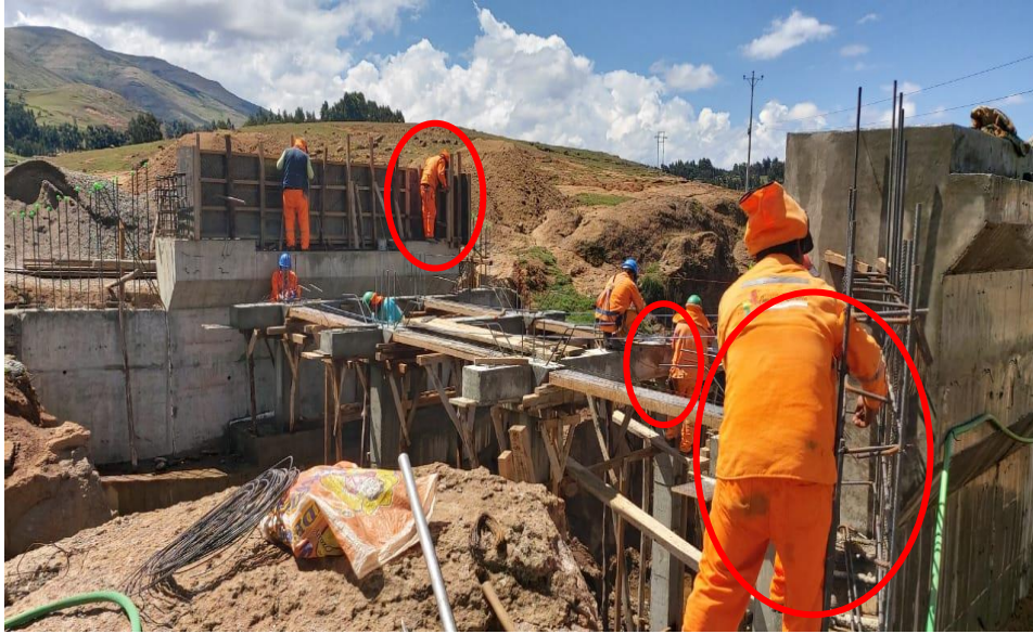
Imagen N° 02 Trabajadores sin arnés de seguridad
