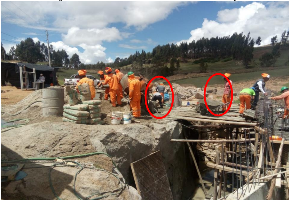
Imagen N° 01 Trabajadores no cuentan con indumentaria completa
