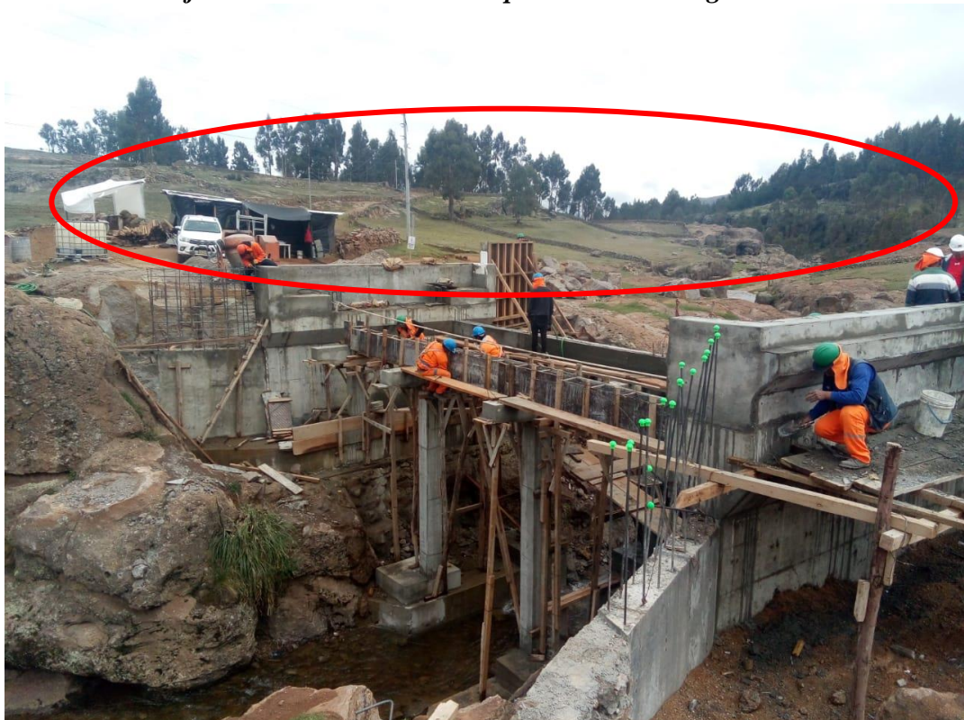
Ejecución de obra sin cerco perimétrico de seguridad
