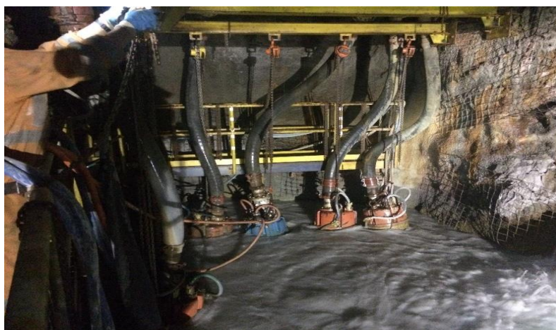
Figura 32. Cámara de bombeo 7 de la mina Islay
