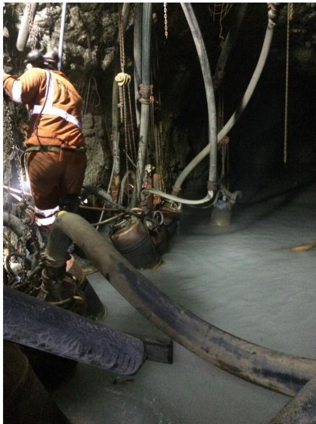
Poza de bombeo 21 (nivel 210)
