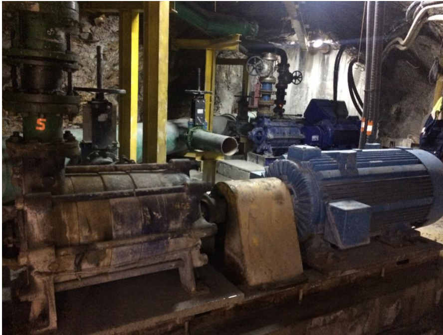
Cámara de bombeo estacionario 1 (nivel 583)
