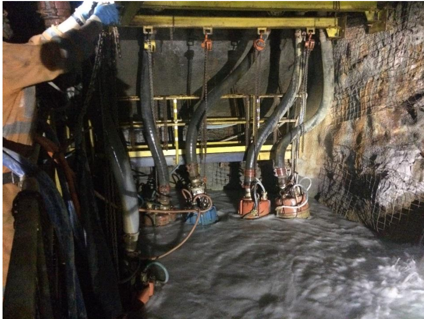
Cámara de bombeo 7 (nivel 270)
