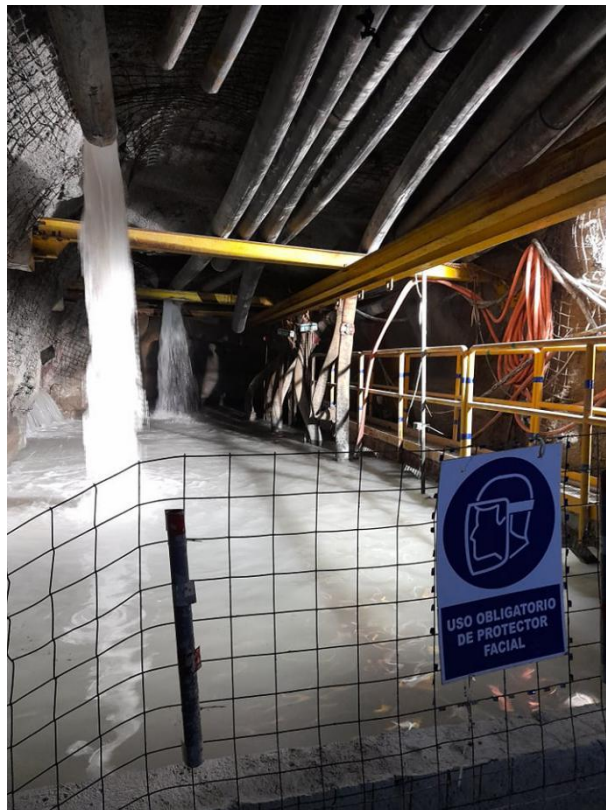
Cámara de bombeo 4 (nivel 370)
