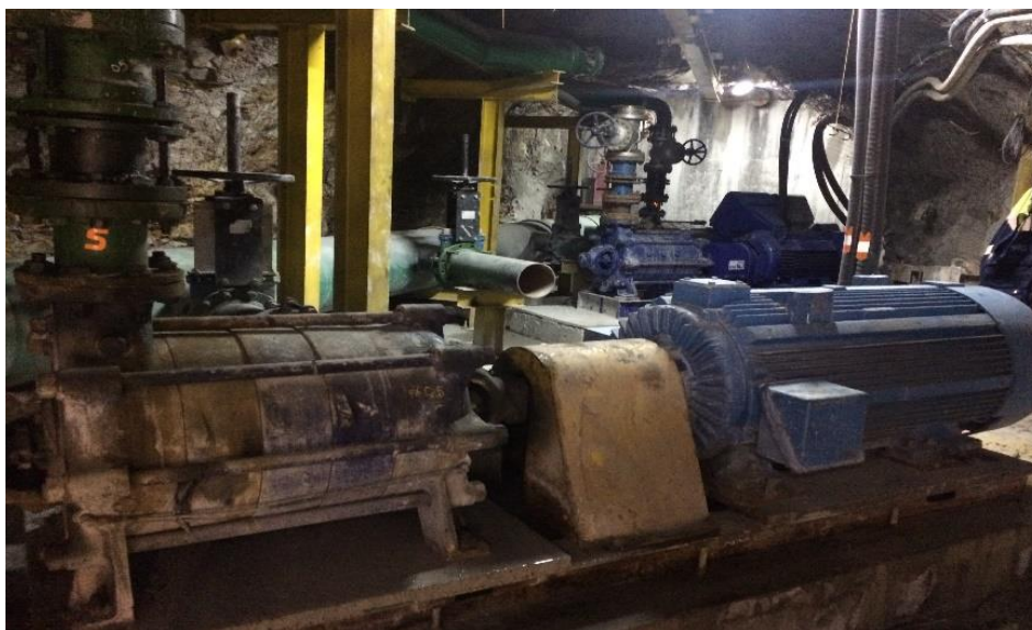
Figura 31. Cámara de bombeo estacionario 1, nivel 583 - mina Islay
