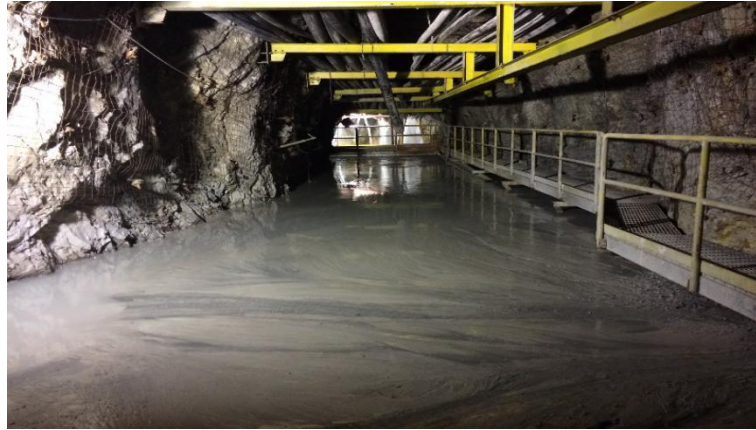
Figura 34. Poza de sedimentación de la cámara de bombeo 7
