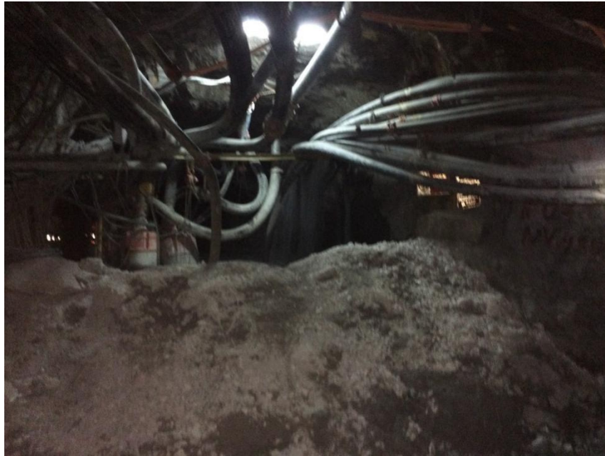
Cámara de bombeo 3 (nivel 420)
