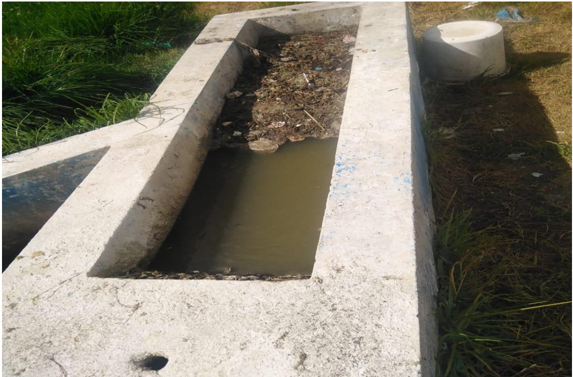
Figura 15. Falta de mantenimiento en la cámara de rejillas gruesas de PTAR -Sapallanga
