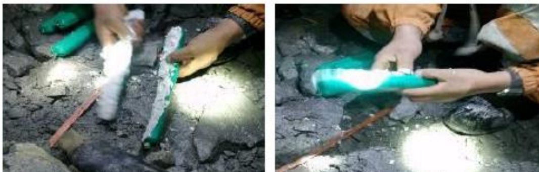
Figura 17. Deficiencias durante el carguío de taladros con el explosivo Emulnor de 1000 de 1 ¼ x 12.
