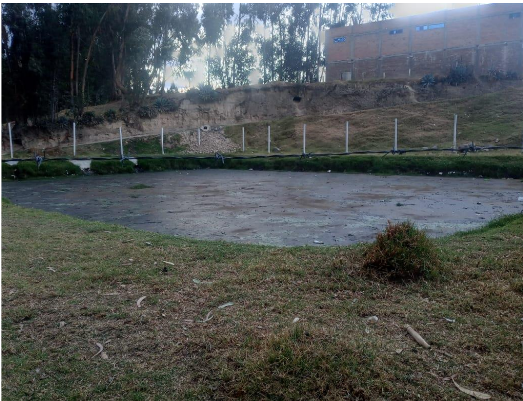
Fotografías 09 y 10. Pozas de estabilización de aguas residuales “San Pablo”.
