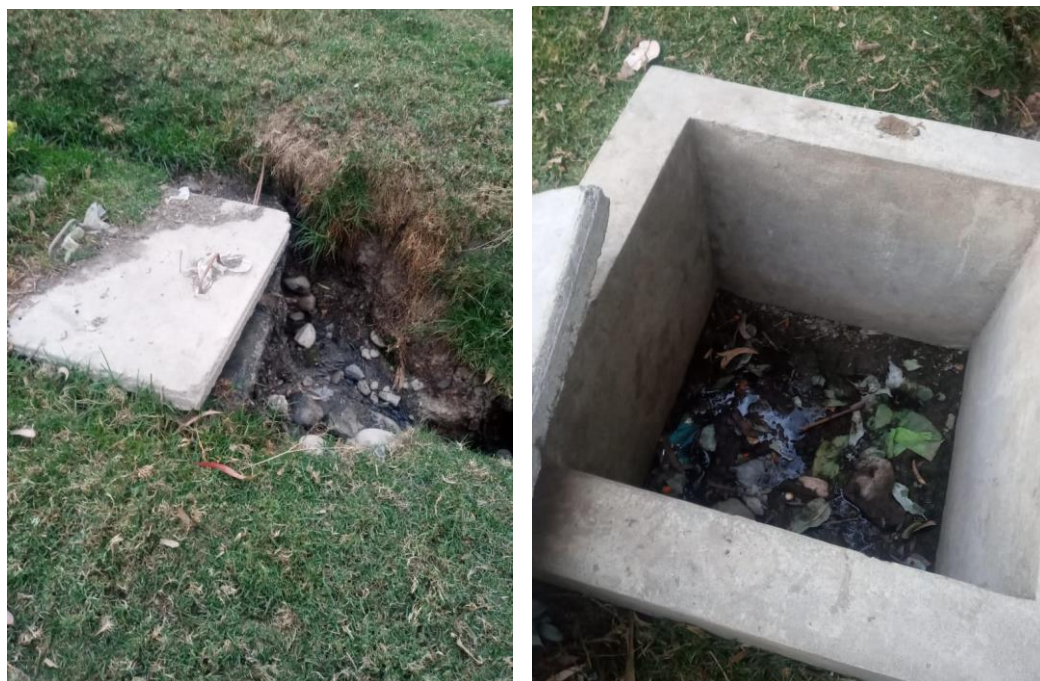
Fotografías 03 y 04. Cajas de control de aguas residuales en inoperancia y sin mantenimiento.
