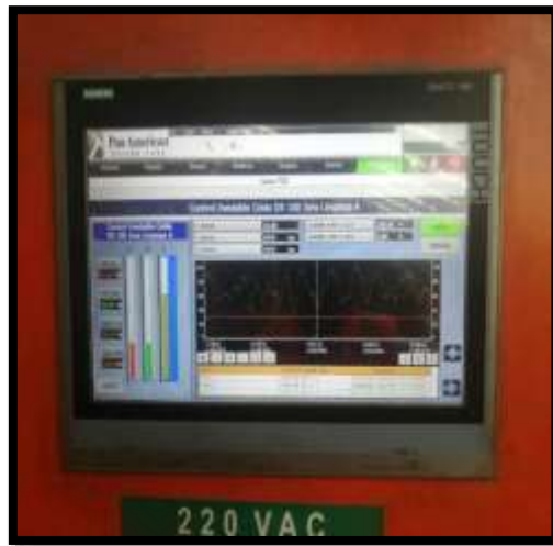
Figura 35. Panel HMI, para control de procesos en la planta concentradora
