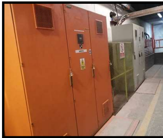
Figura 25. Tablero de banco de condensadores 2
