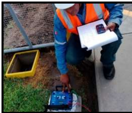
Figura 31. Medición de la poza a tierra con el equipo telurómetro
