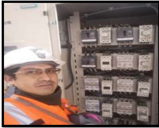
Figura 24. Tablero de banco de condensadores 1
