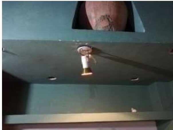
Figura 107: Luminaria tipo proyector
