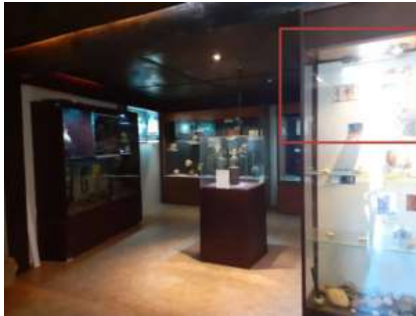
Figura 31: Luminarias LED dentro de las vitrinas
