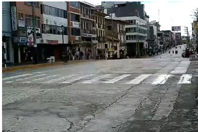
Figura 2: Problemas de fisuras y piel de cocodrilo en la Calle Real - Huancayo.
