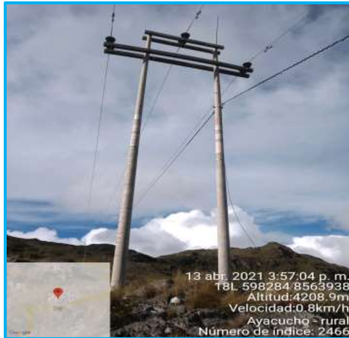
Figura 23. Estructura con mejoramiento de CFO y bayonetas
