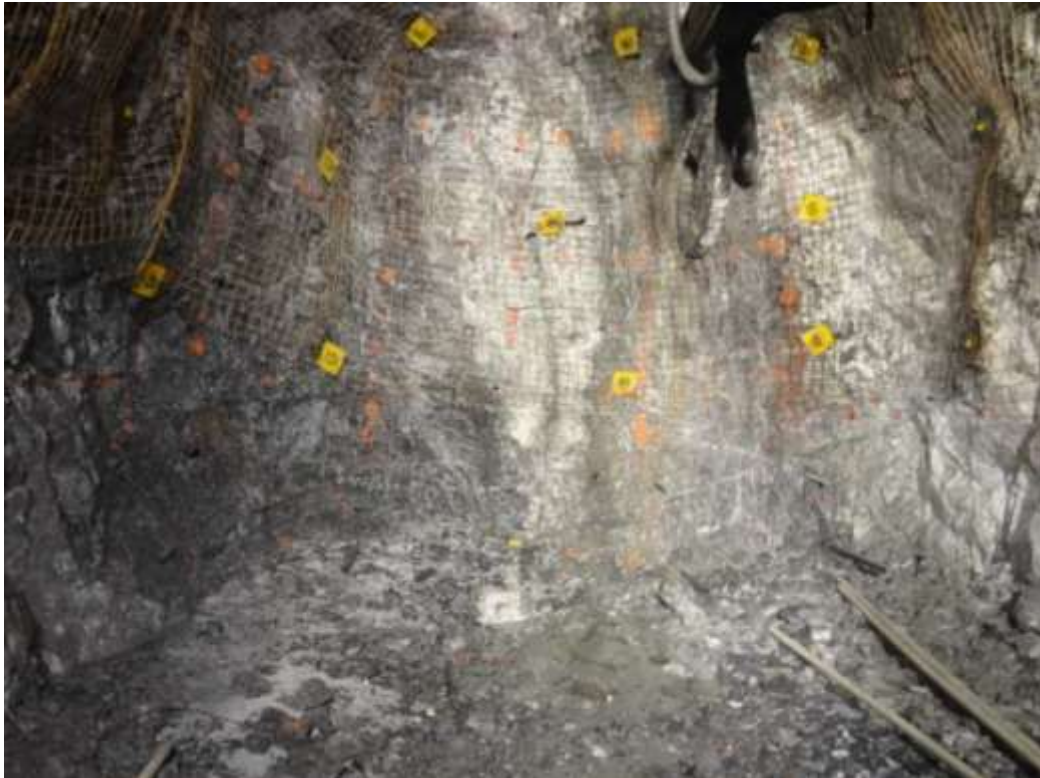
Figura 9. Vista de la rampa 446, instalación de 4 tuberías en los taladros de arrastre
