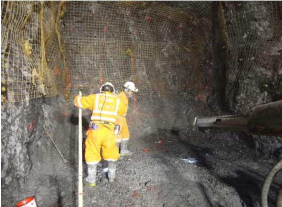
Figura 16. Vista del crucero 406, después de la voladura
